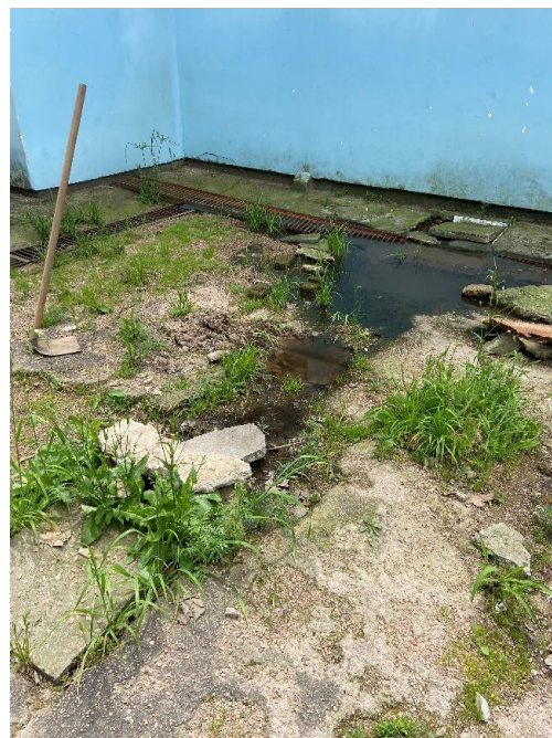
Registro 04: Transbordamento de esgoto.
