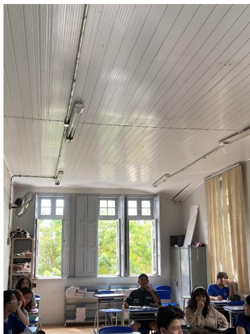
Registro 07 :Forro a ponto de desabar sendo suportado pelo alizar da janela.
