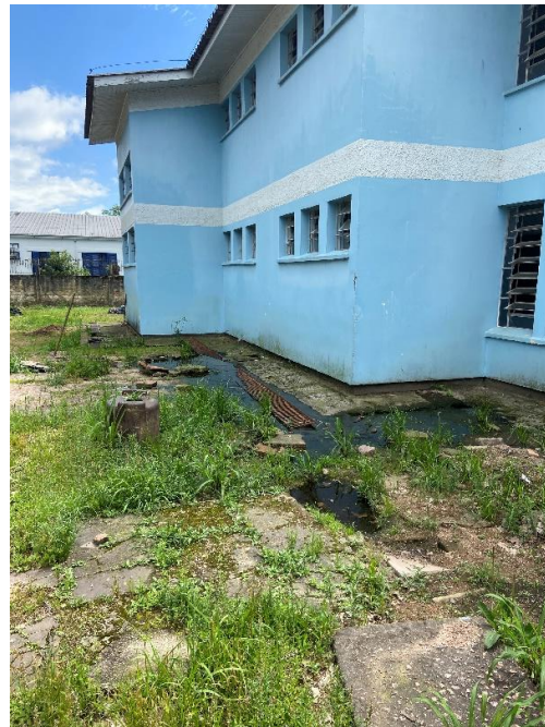
Registro 02: Transbordamento esgoto sanitário.
