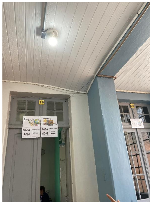
Registro 08: Forro a ponto de ceder no corredor.
