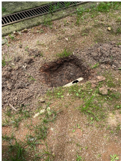
Registro 05: Tubulação rompida em tentativa de reparo malsucedida.
