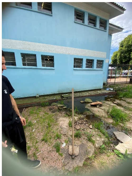
Registro 03: Pátio lateral tomado pelo esgoto.
