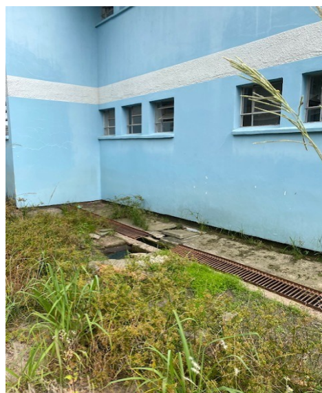
Figura 04 – grelha esgoto pluvial e caixas esgoto cloacal
