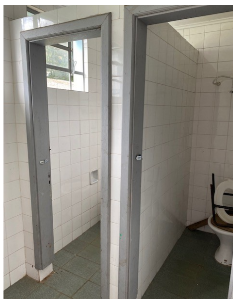
Figura 08 – dois vasos sanitários em cada banheiro
