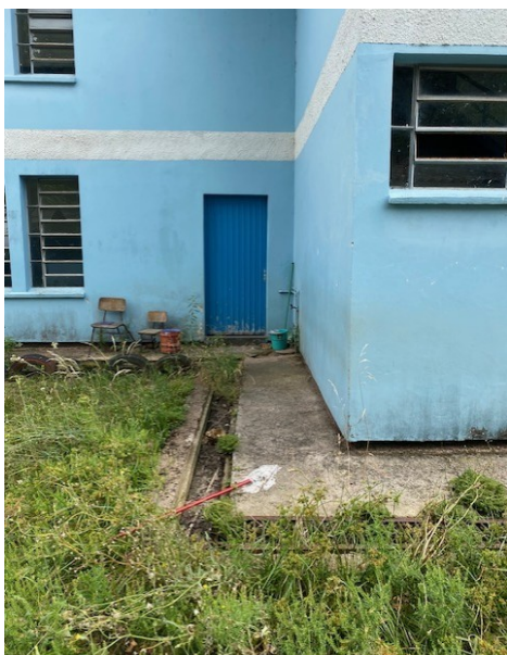
Figura 06 – caixa coletora de esgoto pluvial, sem grelha
