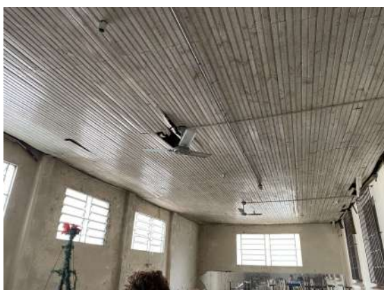
Foto 18 - Sala de Ed. Física com forro, paredes e piso danificados.
