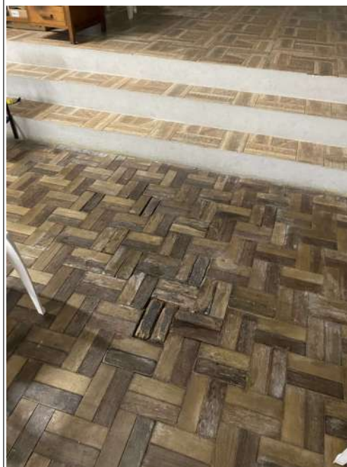
Foto 11 - Piso de madeira podre.
