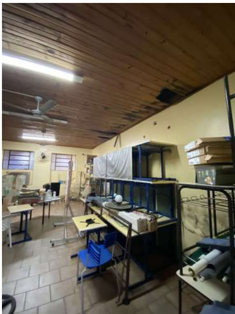
Foto 8 - Forro de madeira apodrecido.
