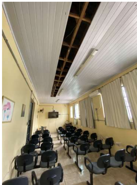
Foto 9 - Forro de PVC solto.
