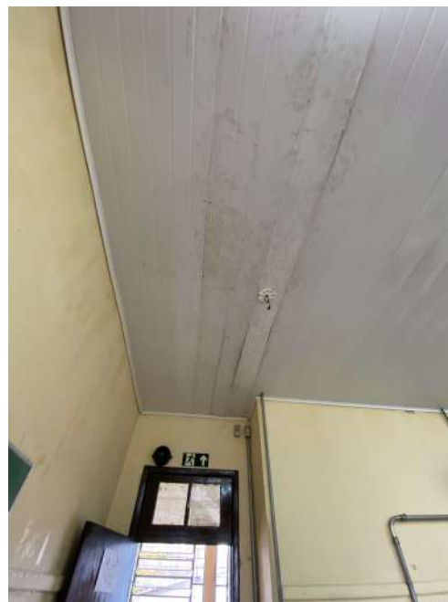
Foto 15 - Paredes e forro de PVC danificados.
