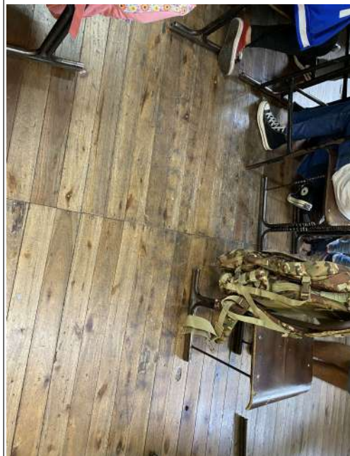
Foto 21 - Piso de madeira danificado.
