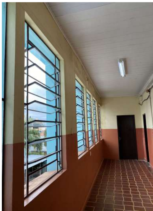
Foto 14 - Paredes e forro de pvc danificados.
