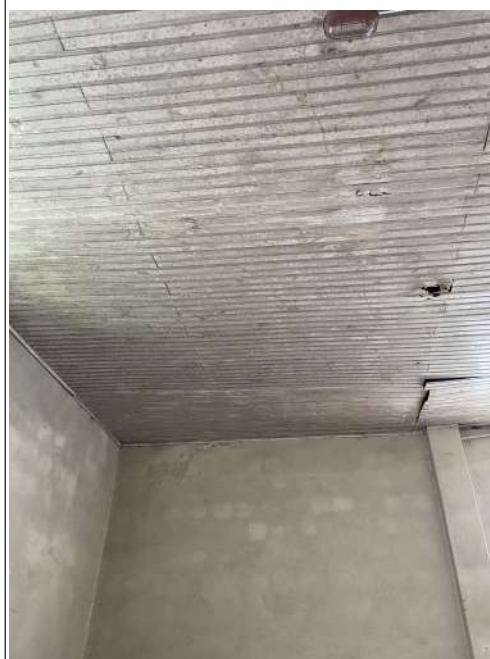
Foto 19 - Forro de madeira e paredes deteriorados.
