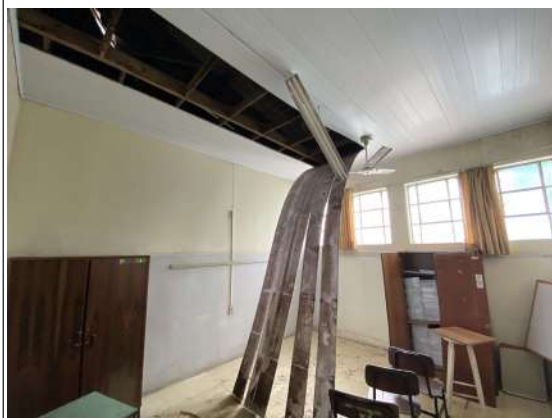
Foto 13 - Forro de PVC solto.
