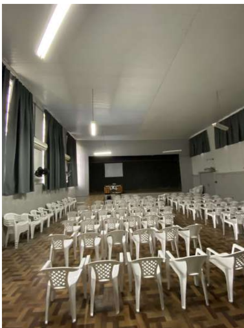
Foto 10 - Auditório com piso, forro e paredes deteriorados.
