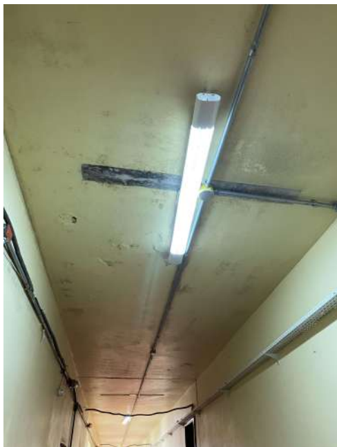
Foto 16 - Teto e paredes danificados.
