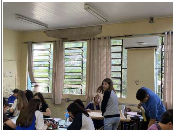
Foto 17 - Forro de PVC e paredes danificados.
