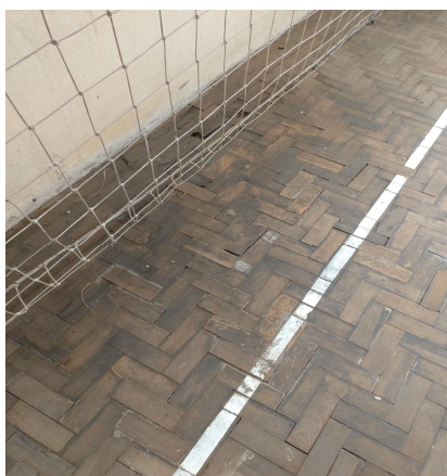
F03: Piso de Parquet/Avariado
