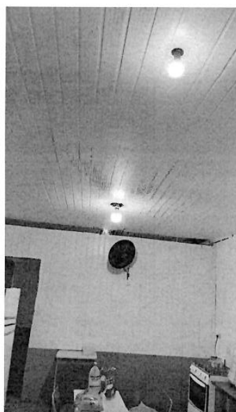
Figura 4: FIAÇÕES SEM ELETRODUTOS NAS
