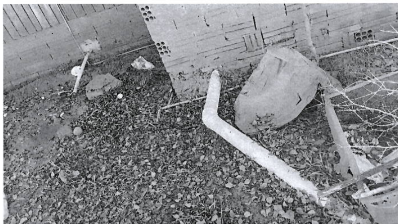
Figura 1: TUBO DE ESGOTO DA COZINHA FALTANDO
