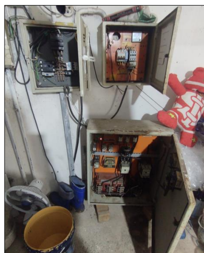
Figura 4. Quadros de comando a serem substituídos.
