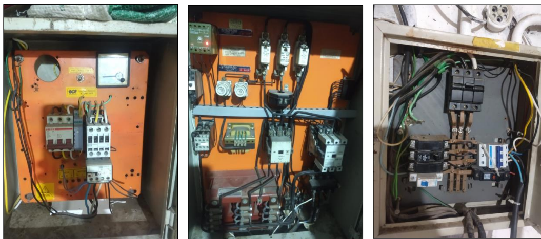
Figuras 5, 6 e 7. Detalhe dos quadros de comando a serem substituídos.
