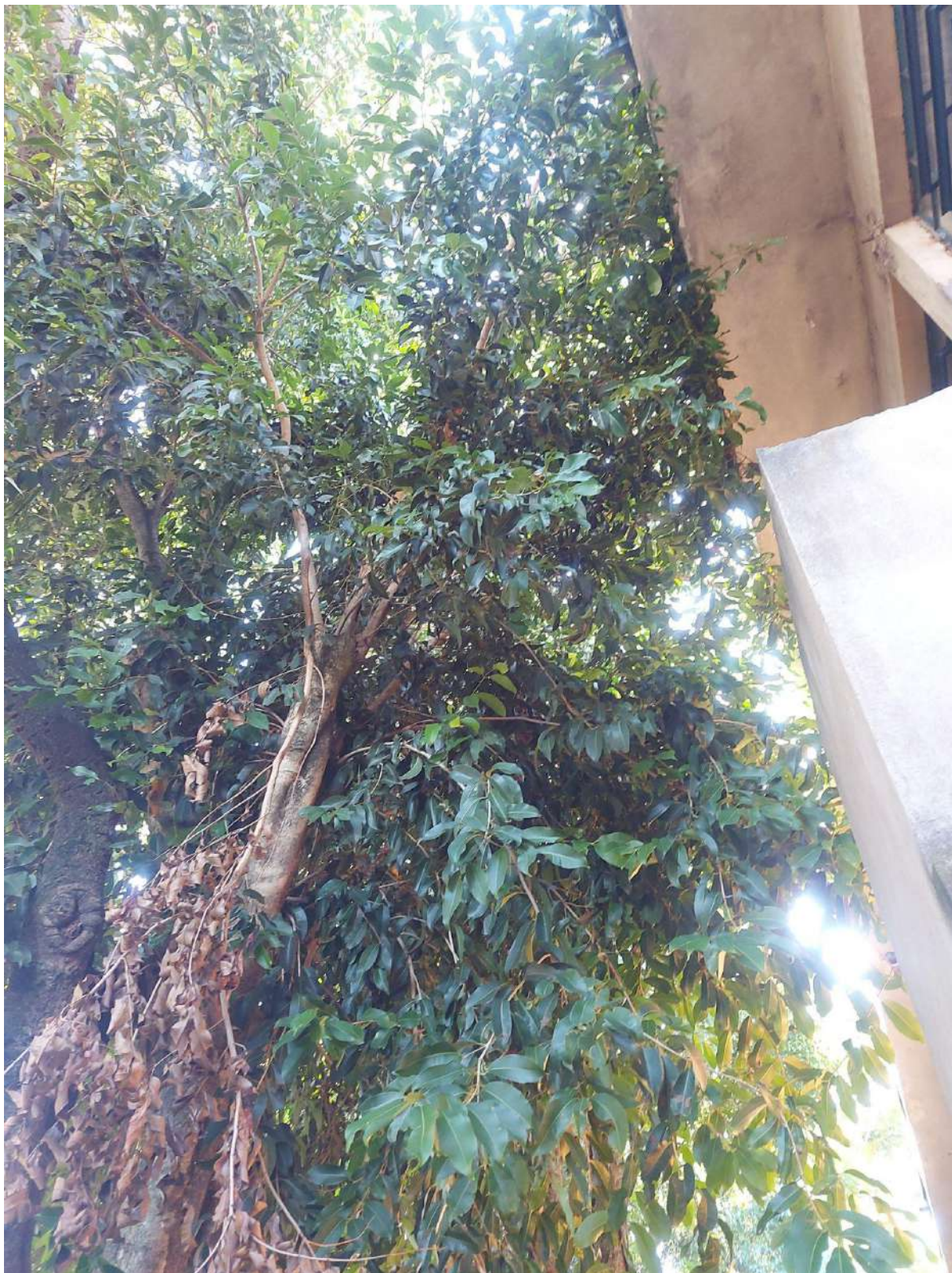
Figura 7. Copa da árvore rente ao prédio.
