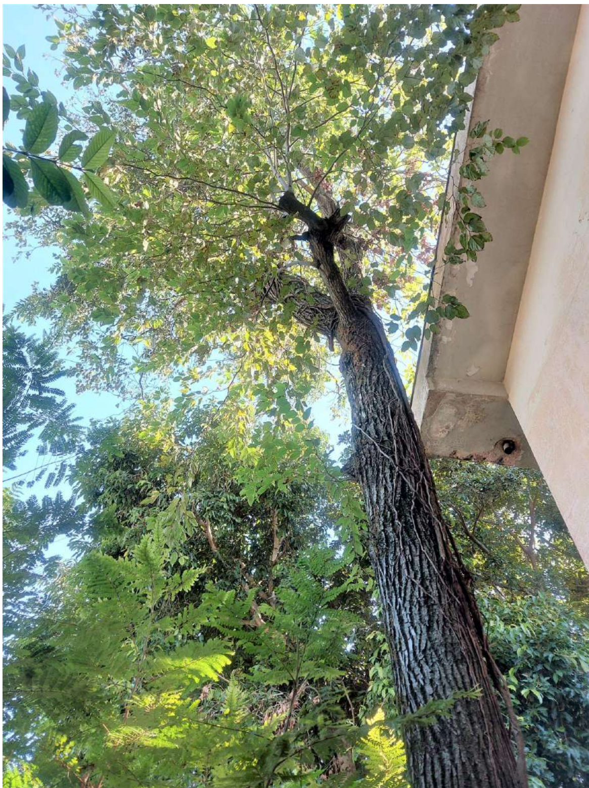
Figura 4. Proximidade da árvore com o prédio da escola.
