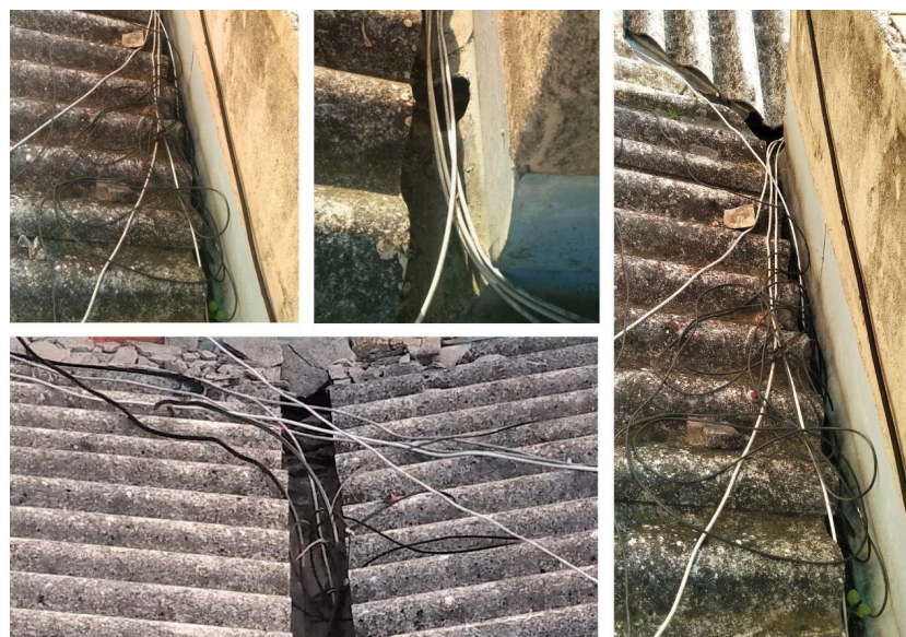
Figura 7: Fiação elétrica exposta.
