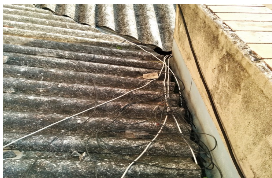
Figura 4: Fiação Elétrica Exposta
