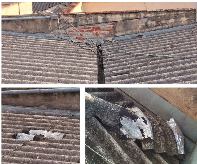
Figura 3: Pontos de Infiltração
