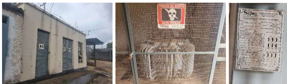
Figura 2 - Imagens da Subestação
