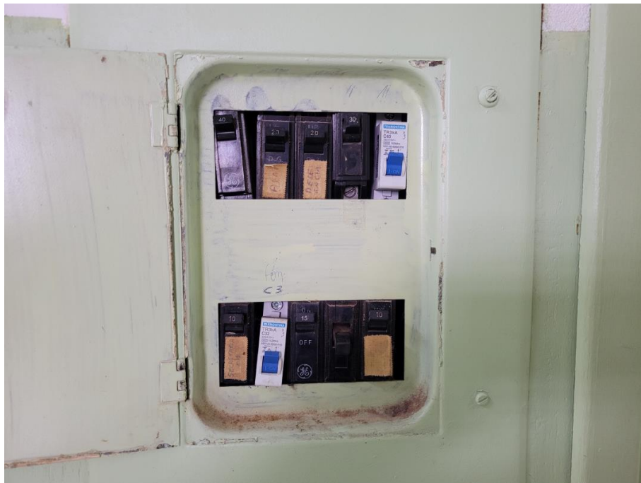
Imagem 8 – Quadro de Distribuição.
