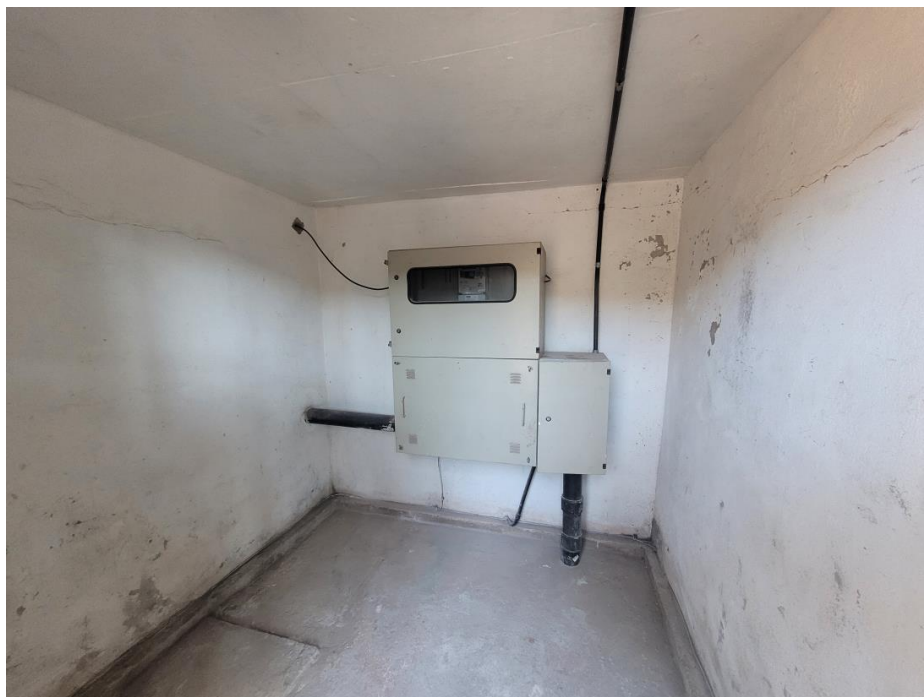
Imagem 4 – Cabine de medição.
