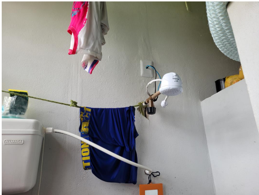
Imagem 12 – Chuveiro sem condutor Proteção.
