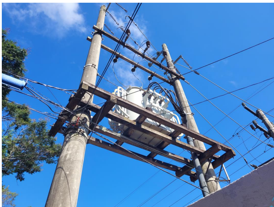
Imagem 3 – Transformador da subestação.
