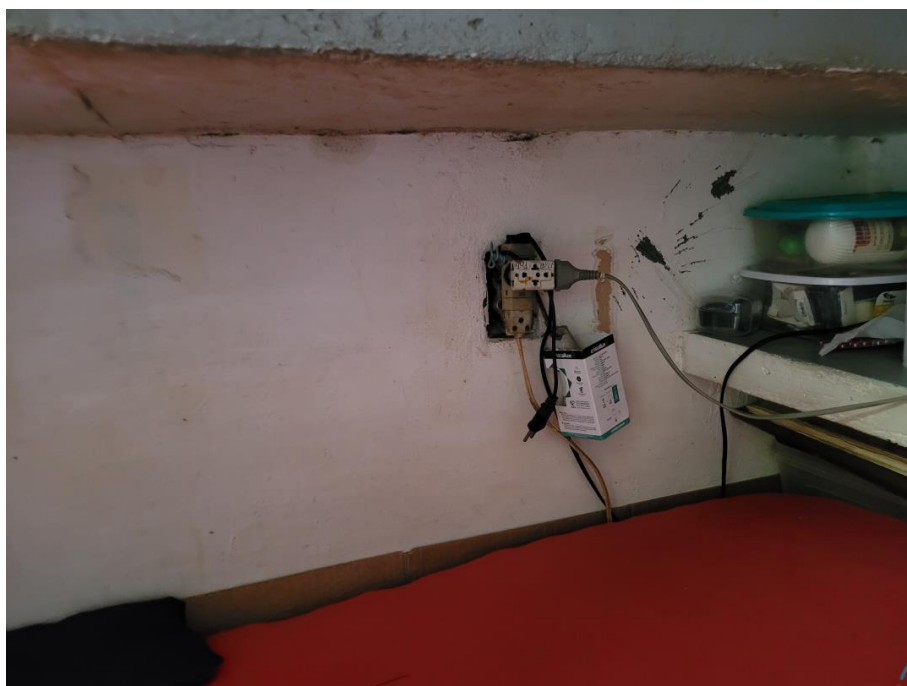
Imagem 13 – Utilização de “T” em tomadas.
