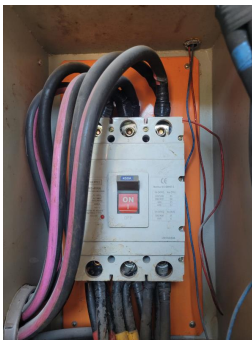
Imagem 5 – Disjuntor Geral, com In = 450A.
