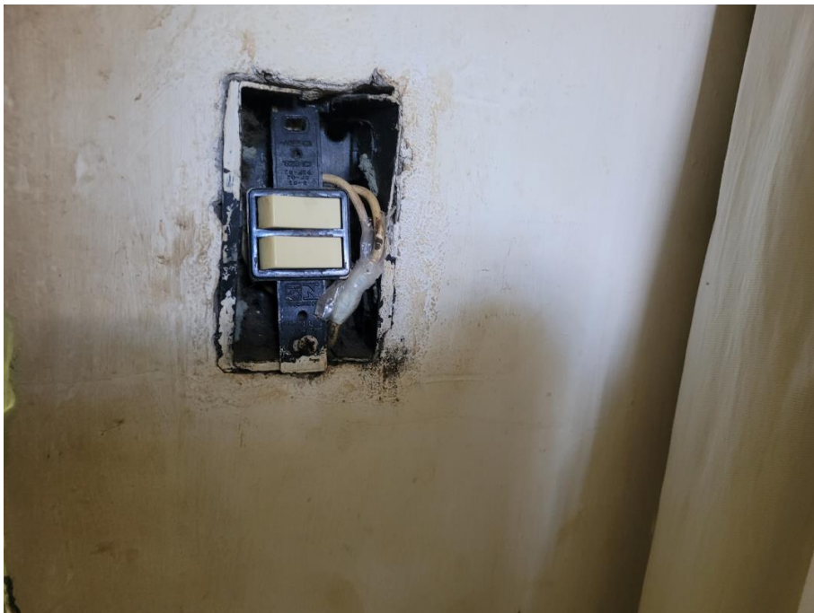
Imagem 14 – Interruptor com fiação aparente.
