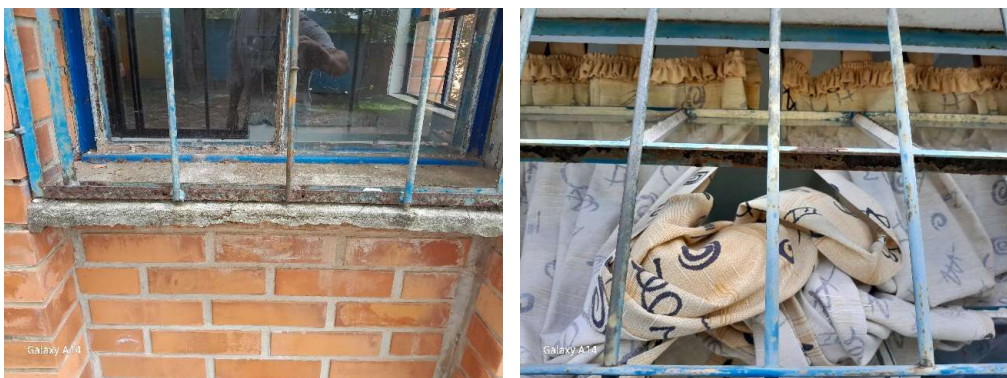
Figura 14 – Imagens Estado atual do Sistema de Pisos e Pavimentação do Pátio Interno
