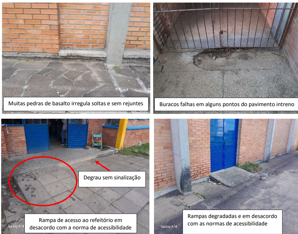
Figura 13 – Imagens Estado atual do Sistema de Pisos e Pavimentação do Pátio Interno
