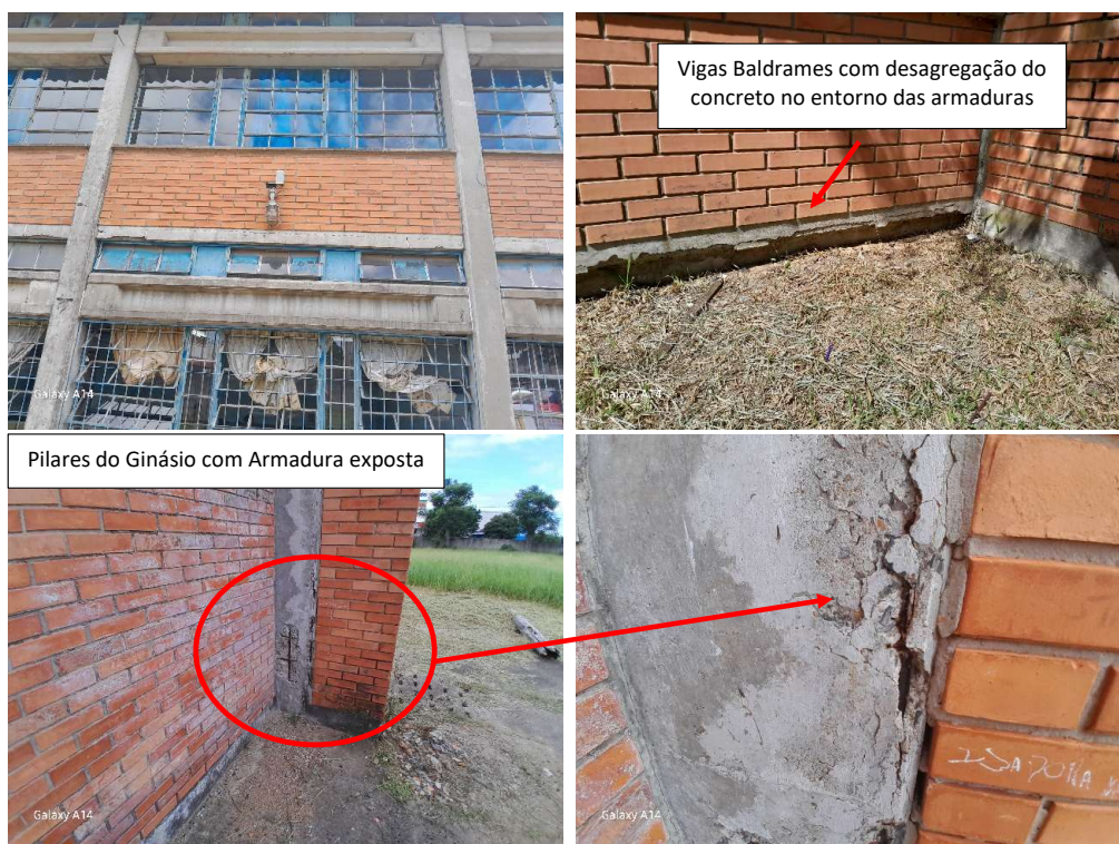
Figura 06 – Imagens Manifestações Patológicas Estruras de Concreto
