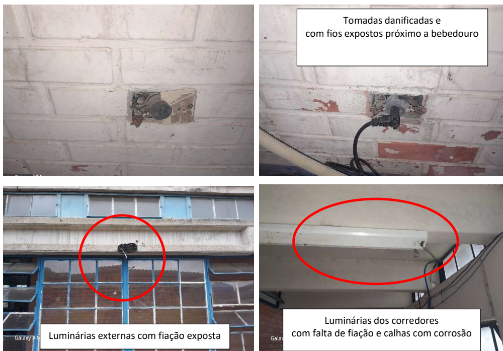
Figura 16 –imagens por fotos das anomalias nas instalações elétricas
