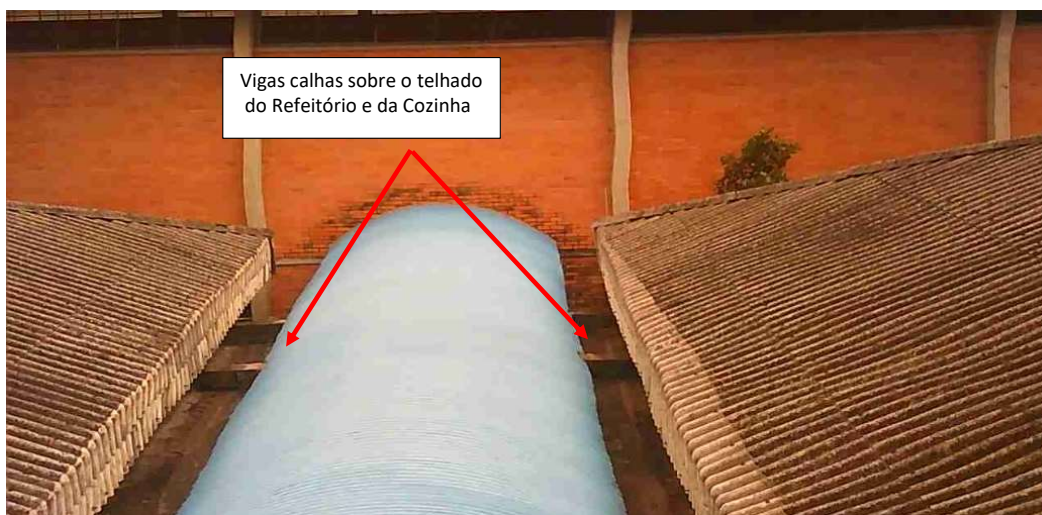
Figura 12 – Vigas-calhas localizadas no refeitório e cozinha com infiltrações
