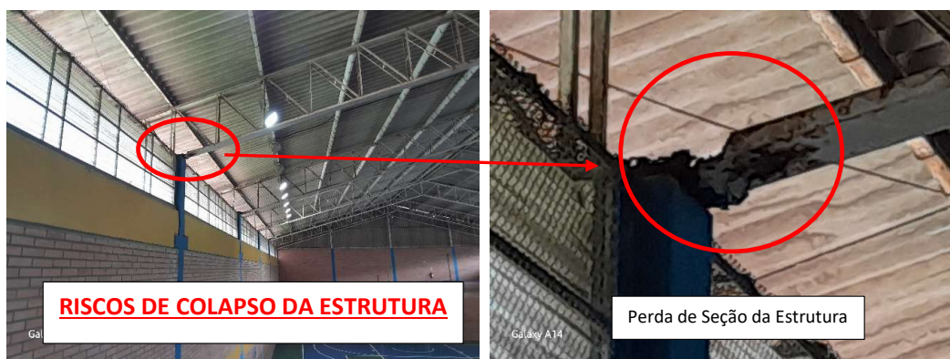
Figura 11 – Estruturas do telhado do ginásio comprometidas
