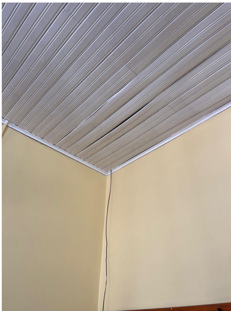
Foto 10 – Sala com danos no forro
