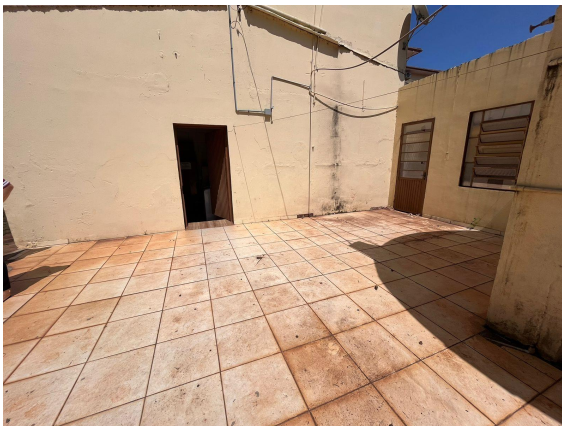
Foto 02 – Pátio com marcas de alagamento
