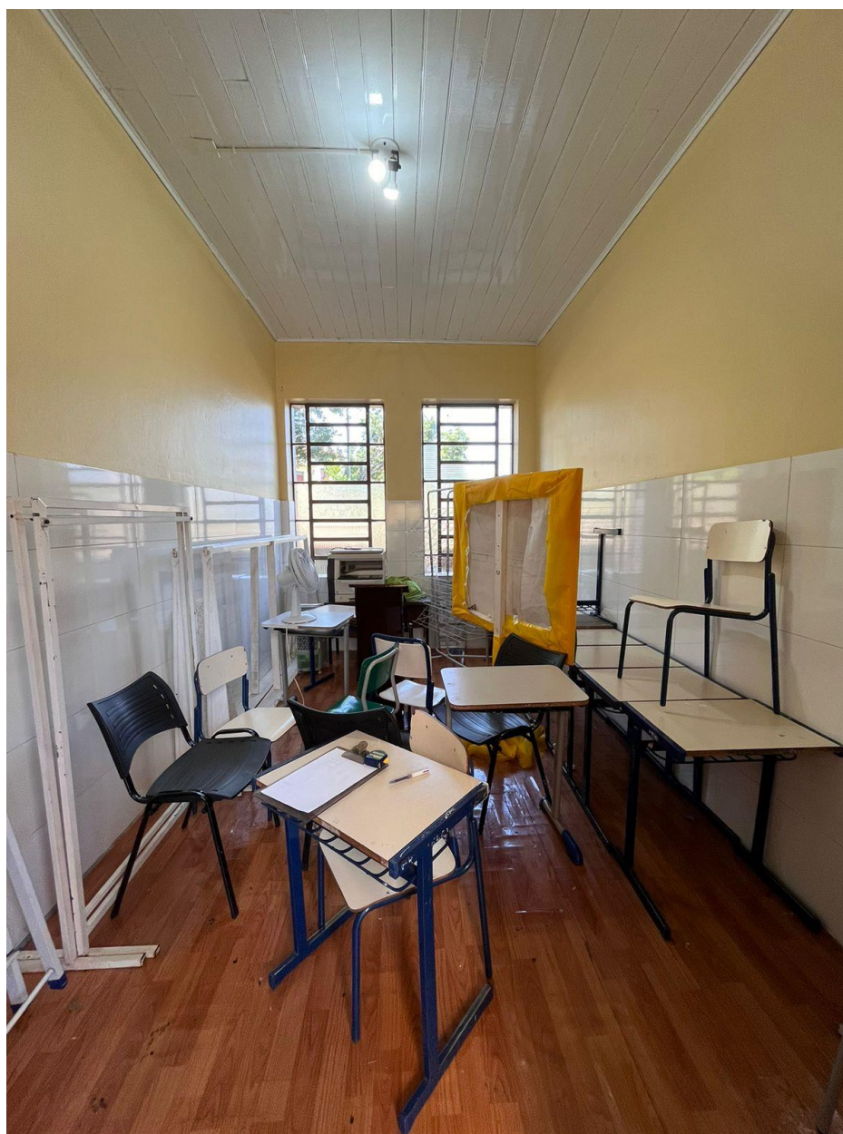
Foto 05 – Sala com danos de água
