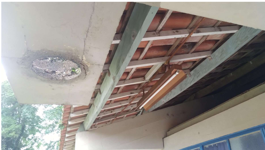
Foto 05 – calha em concreto no bloco 01 necessitando recuperação
