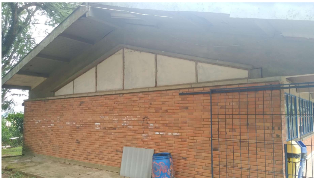
Foto 06 – beirado em lambri de madeira deteriorado no bloco 02
