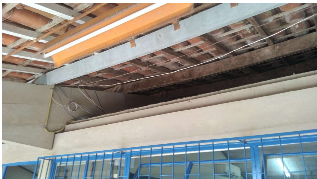
Foto 09 – instalações elétricas comprometidas e insuficientes para a atual demanda da escola
