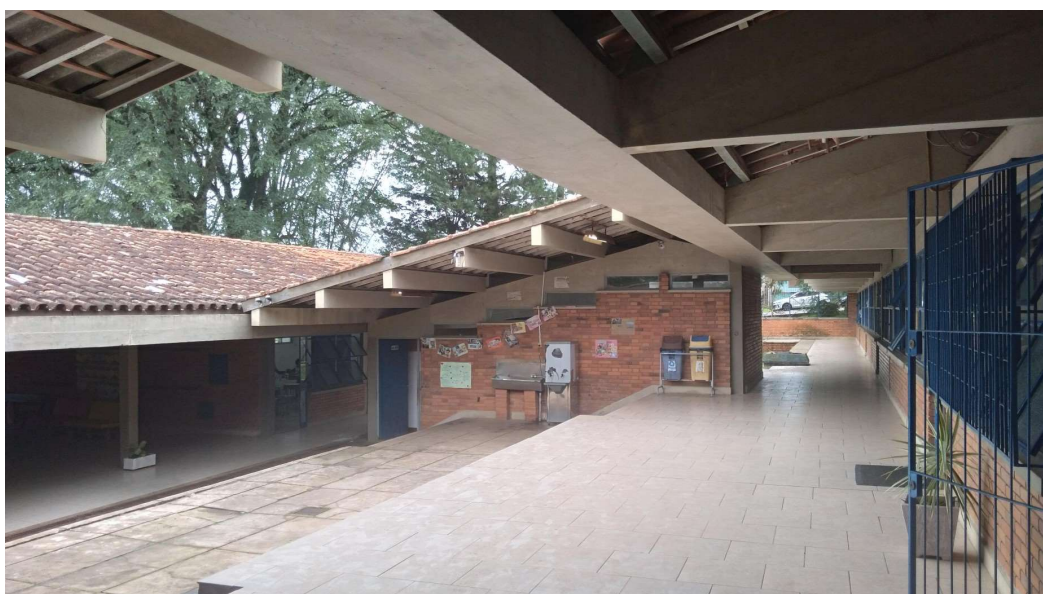
Foto 04 – cobertura do bloco 02 deteriorada
