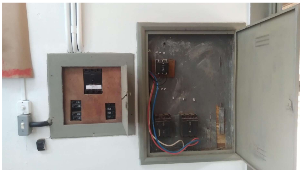
Foto 11 – quadro de disjuntores existente
