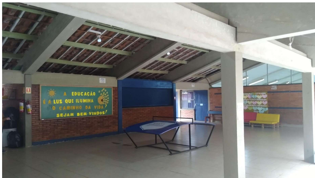
Foto 01 – Saguão da escola com telhas quebradas e faltantes
