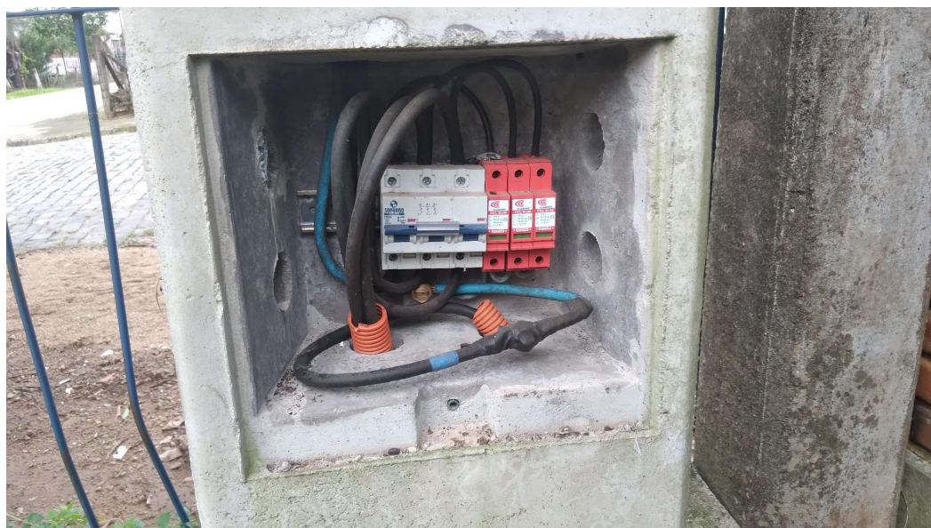
Foto 12 – entrada de energia existente com fornecimento de rede trifásica
