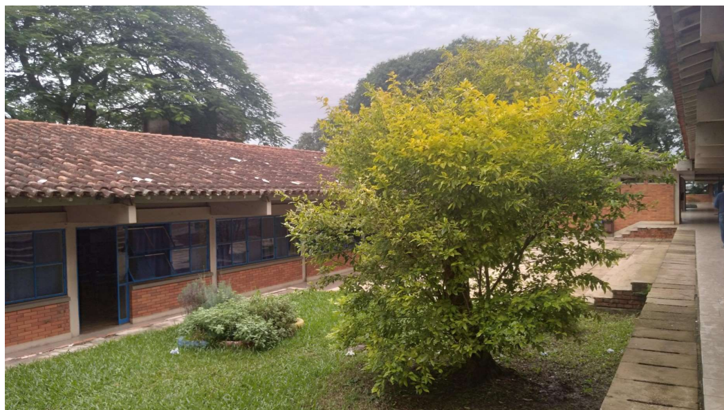
Foto 02 – Cobertura do bloco 02 com trechos de manta asfáltica, improvisando reparos na cobertura
