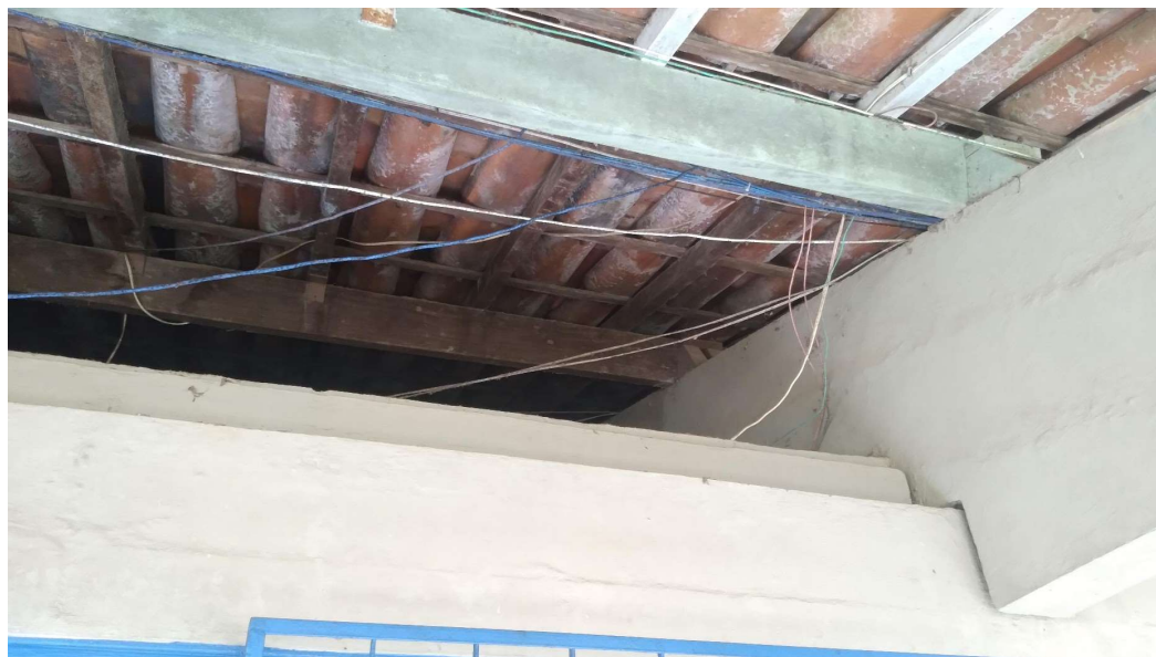
Foto 07 – fiação exposta no bloco 02
