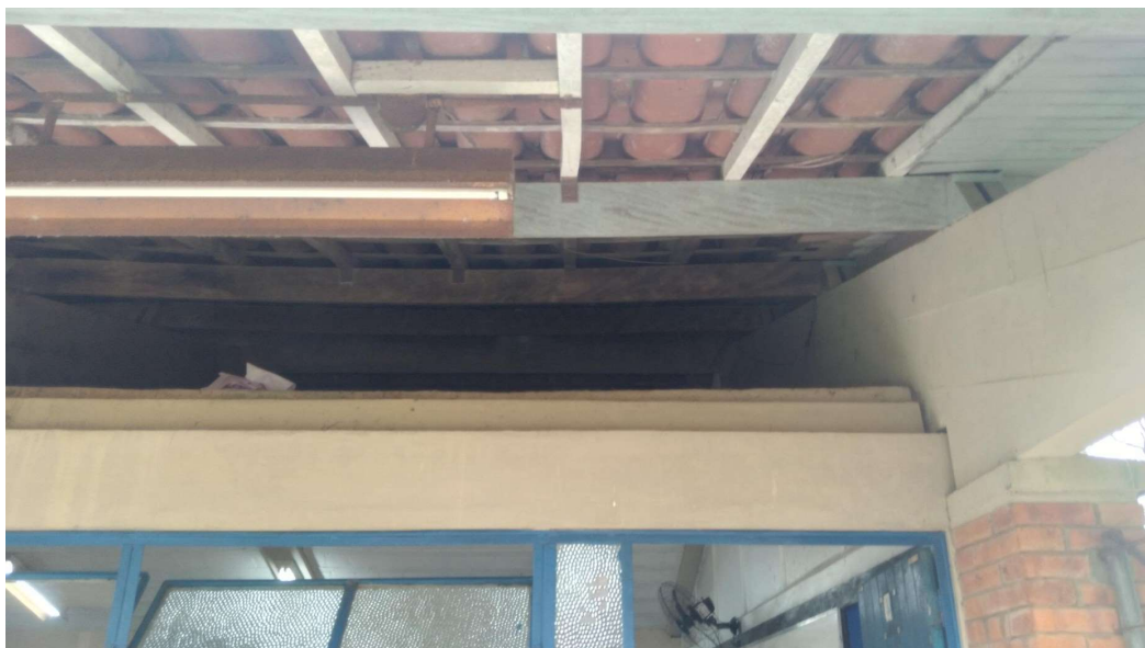
Foto 03 – estrutura em madeira apresentando recalque, evidenciando a perda de resistência do material
