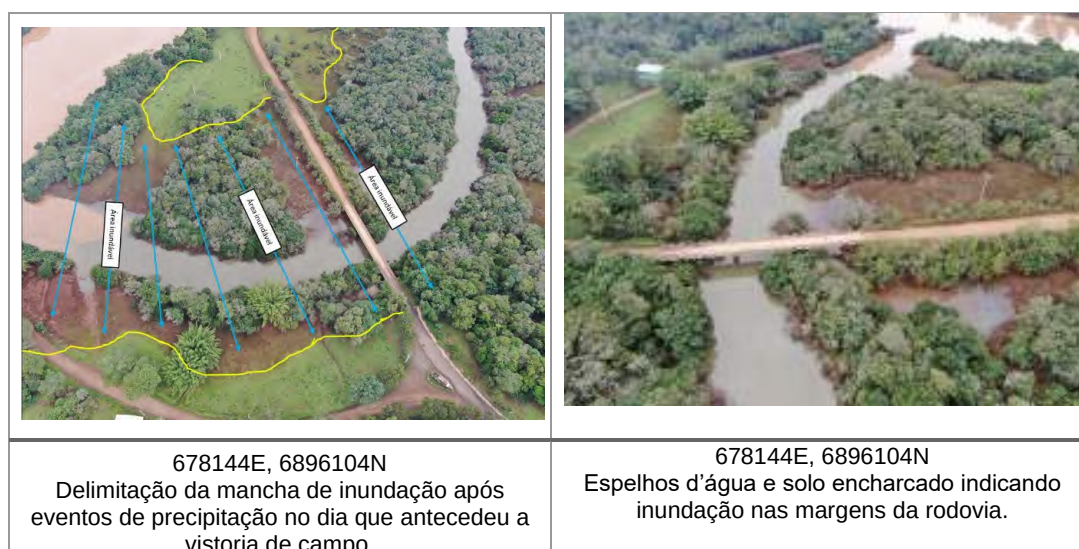
Figura 2.2.22 - Local de inundação do greide e da ponte da ERS-550.
