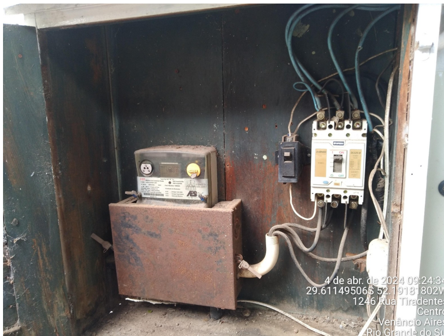
foto 03 – quadro de medição atual com a capacidade incompatível com a carga atual da escola
