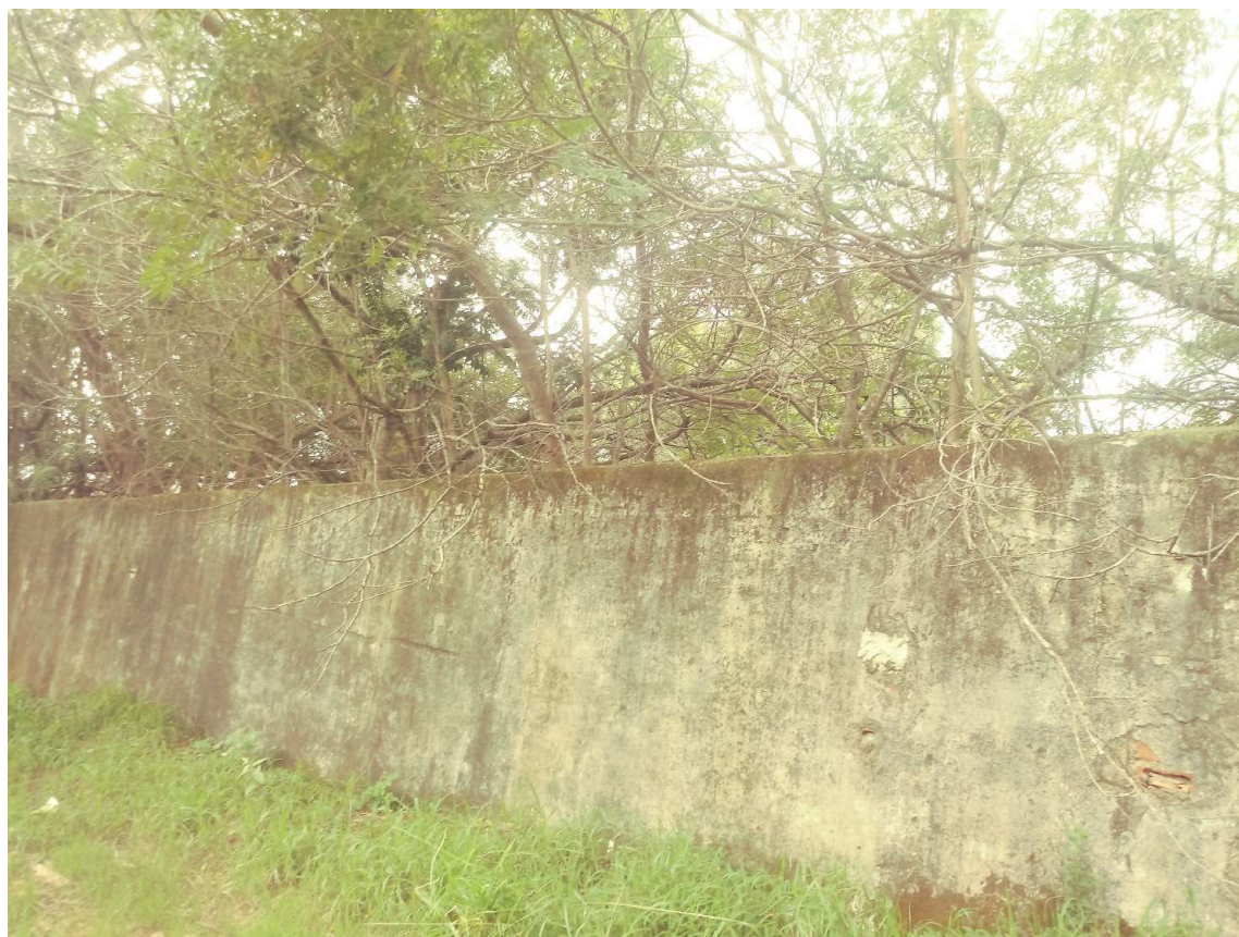
Muro com forte inclinação para o terreno da creche, as árvores deverão ser retiradas.
