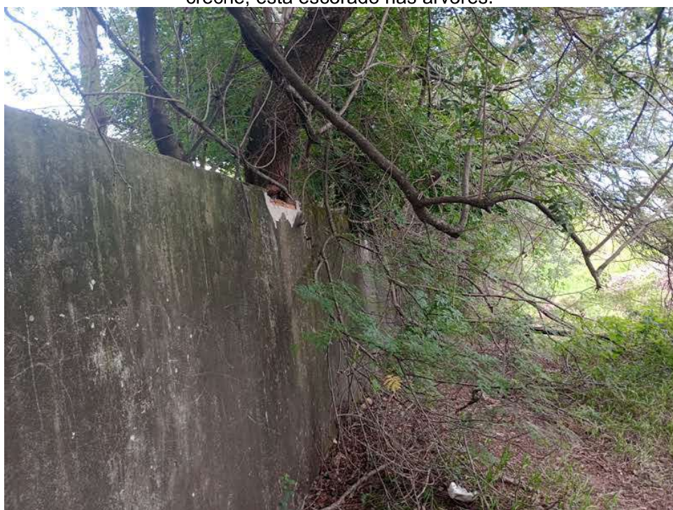
Muro de divisa a leste junto a creche Ao Neusa, apresenta forte tombamento para o terreno da creche, está escorado nas árvores. Foto abaixo.
