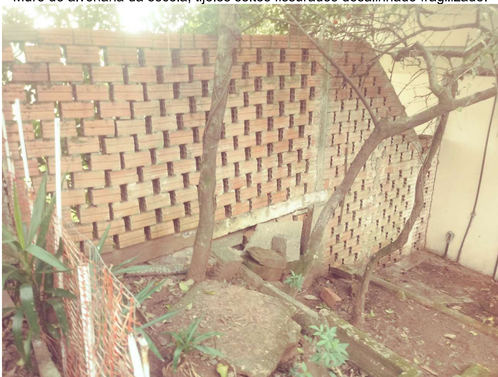
Muro de alvenaria da escola, tijolos soltos fissurados desalinhado fragilizado.
