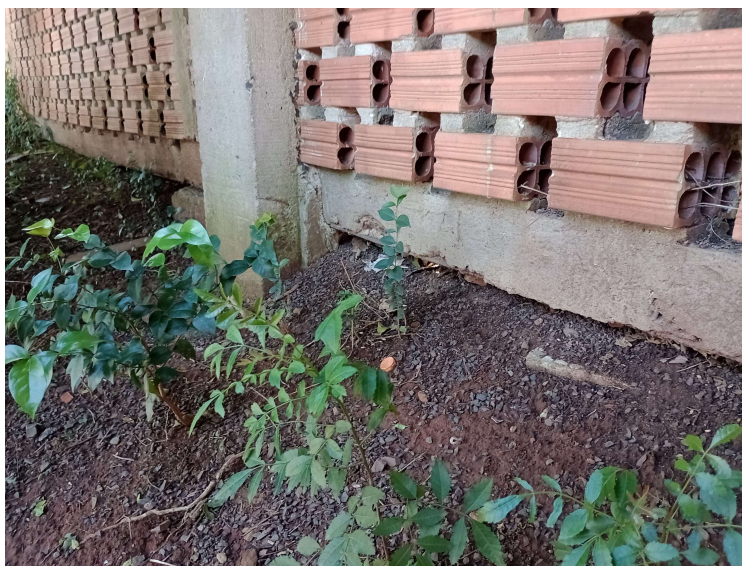
Fundação no ar, do muro vazado de tijolos sem qualquer apoio ver foto acima.
