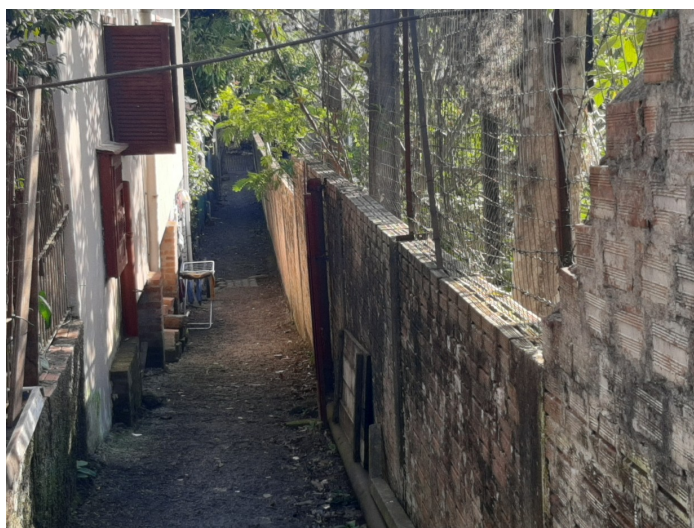
Figura 2 – Muro lateral, de divisa (sul) com deformação no eixo vertical
