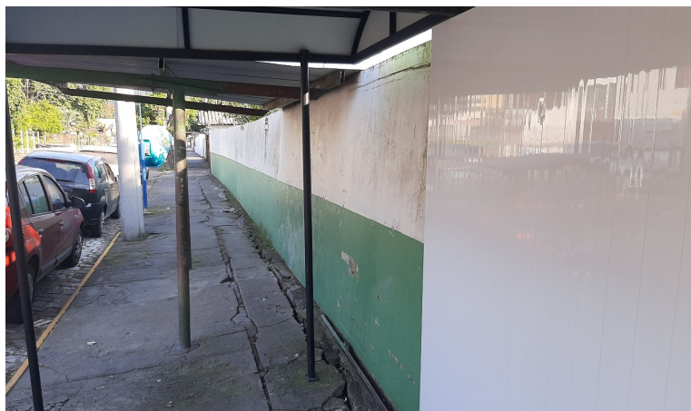
Figura 1 – Muro frontal (leste) com deformação acentuada; passeio público deformado e deteriorado.
