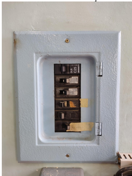
Figura 1 – QD Geral com disjuntores antigos, carga muito baixa para comportar os equipamentos atuais da escola.
