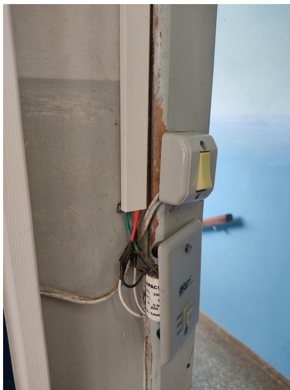
Figura 2 – Instalações precárias, com fios aparentes, isolamento precária.
