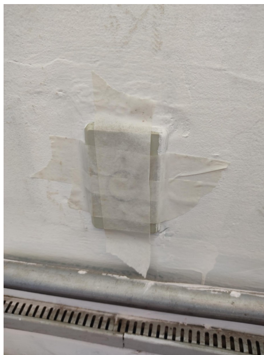
Figura 4 – Tomadas isoladas pois estão todas derretidas e não podem mais ser usadas, fiação comprometida.
