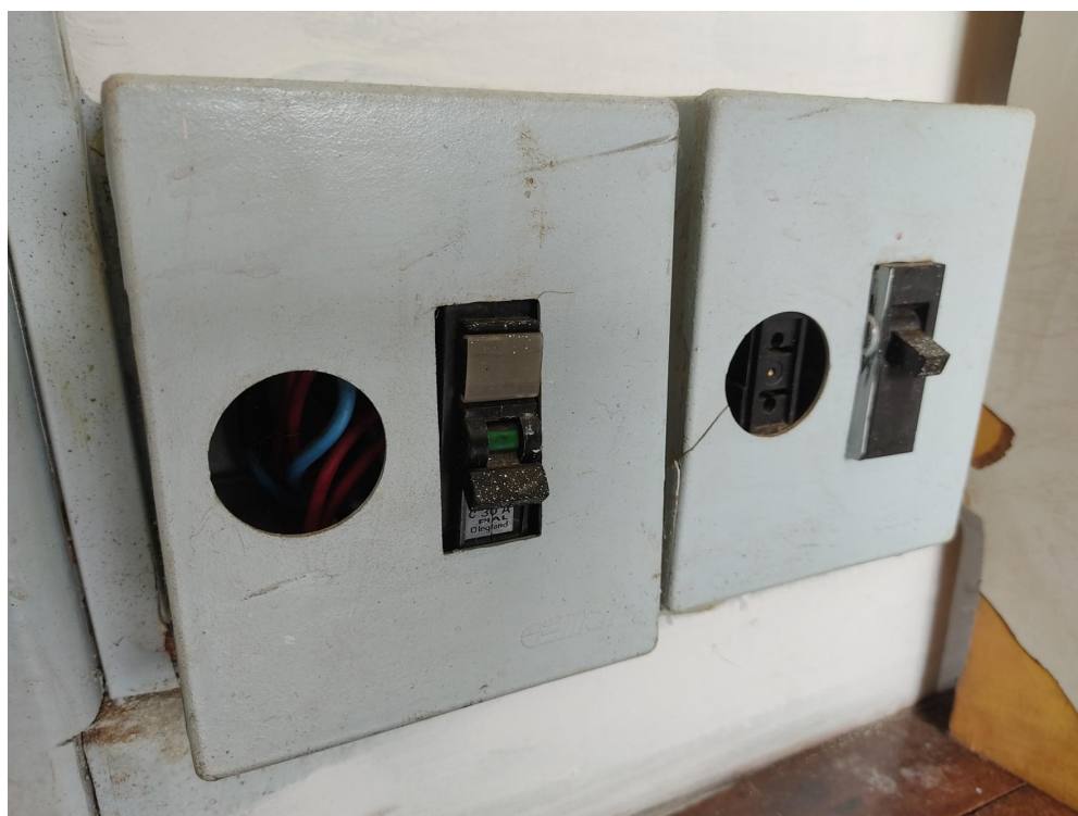
Figura 5 – Tomadas antigas com isolamento e proteção comprometida.
