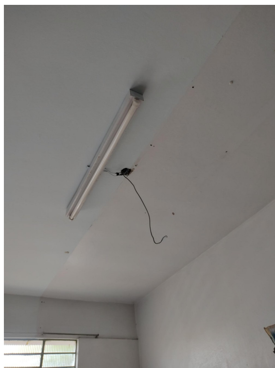
Figura 3 – Instalações precárias, com fiação exposta e sem isolamento.
