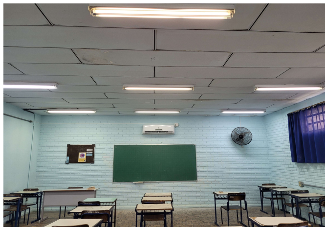
Foto 10 – Umidade forro Sala de Aula
