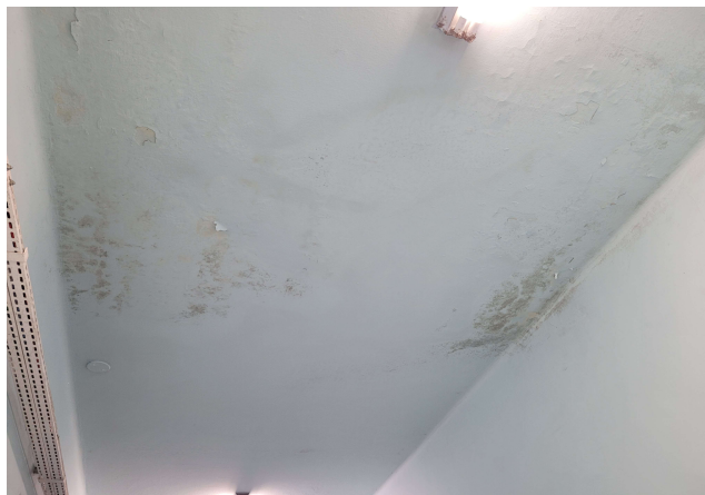
Foto 01 – Umidade laje da escola
