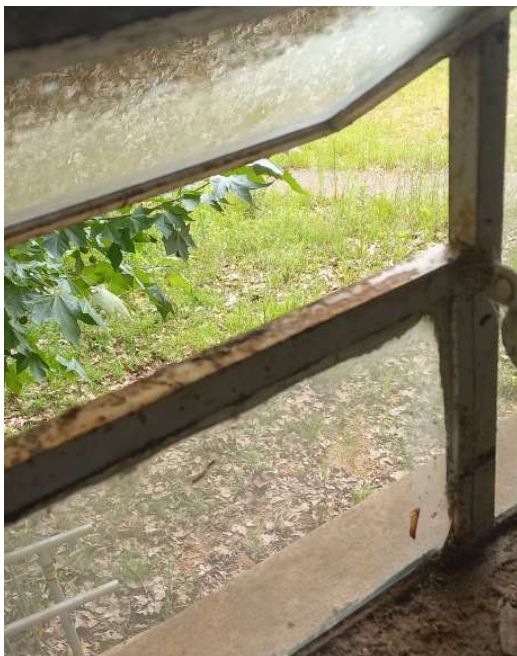
Figura 34: Janela com ferrugem (Fotos 11/2023).
