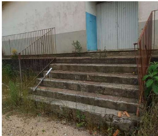
Figura 52: Escada sem corrimão adequado e com degraus em desacordo (Fotos 11/2023).
