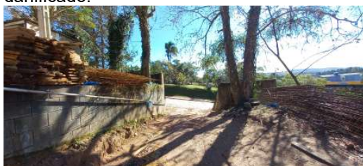
Figura 74: Rampa de acesso de veículos e cadeirantes danificada.
