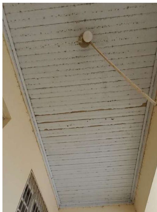
Figura 16: Forro acesso escola (Fotos 11/2023).
