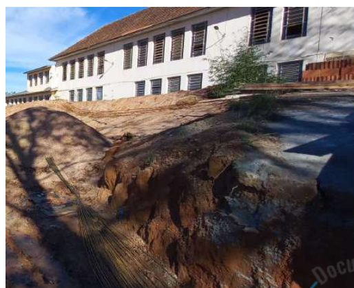
Figura 47: Acesso PcD a ser reconstruído pelo vizinho.
