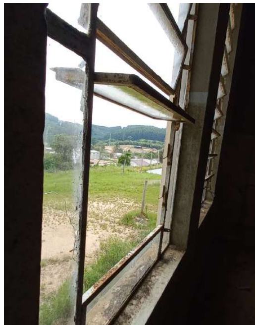
Figura 35: Janela sem vidros e com ferragem estragada (Fotos 11/2023).
