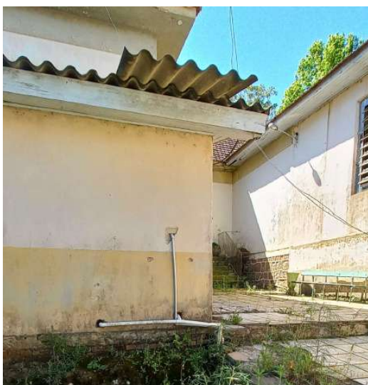
Figura 68: Tubulações da lavanderia (Fotos 11/2023).
