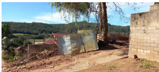
Figura 72: Acesso de veículos com porta danificada.
