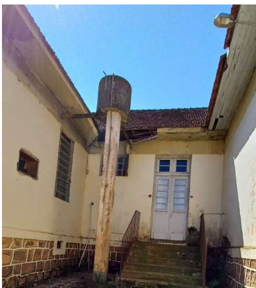
Figura 50: Escada sem corrimão adequado e com degraus em desacordo (Fotos 11/2023).
