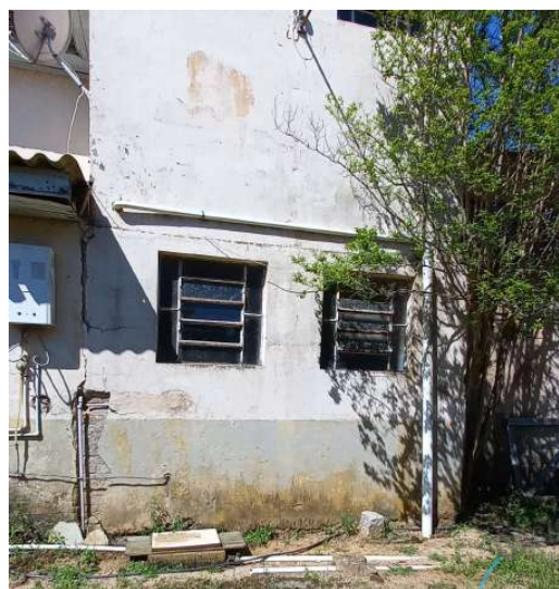
Figura 69: Tubulações da cozinha (Fotos 11/2023).
