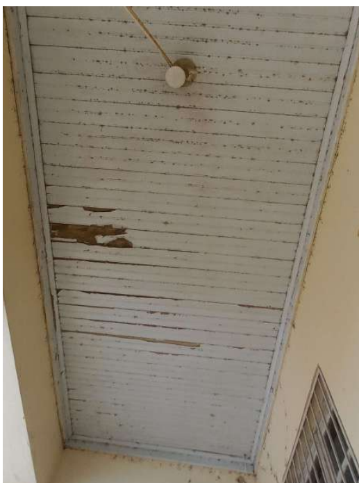
Figura 15: Forro acesso escola (Fotos 11/2023).
