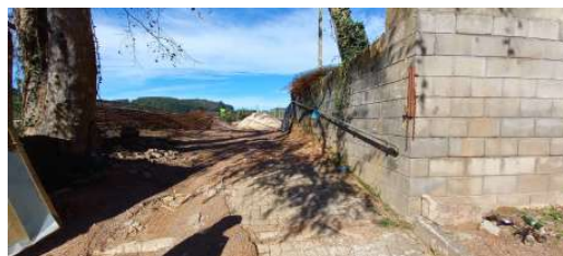
Figura 73: Rampa de acesso de veículos e cadeirantes danificada.
