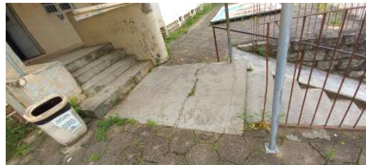
Figura 41: Falta de rampa para acesso ao térreo (Fotos 11/2023).
