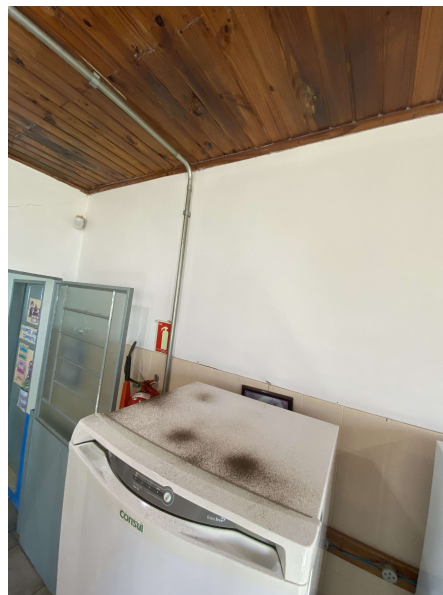
Foto 17 - Forro da cozinha danificado, com pontos apodrecidos e resíduos que evidenciam a presença de cupins.
