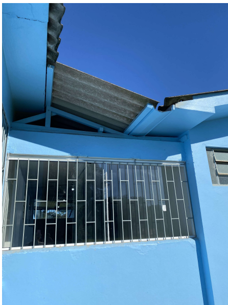
Foto 8 - Calha danificada e dimensão insuficiente ao escoamento.
