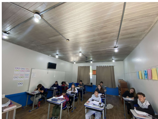
Foto 12 - Forro de madeira das salas de aula com manchas de bolor.
