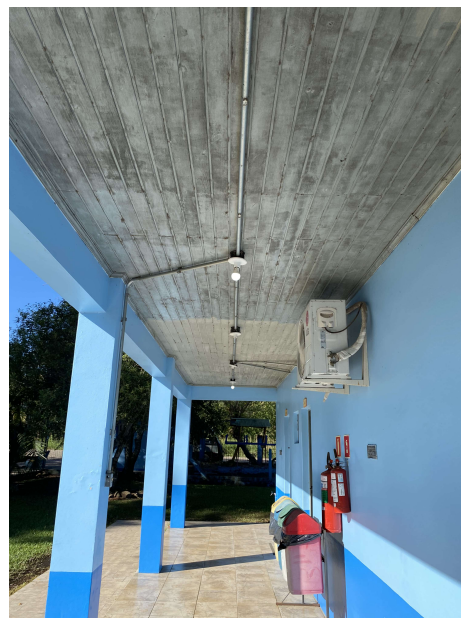
Foto 11 - Forro de madeira da circulação externa com manchas de bolor.
