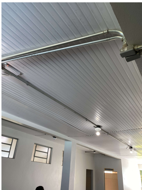
Foto 14 - Forro de PVC do refeitório abaulado e desprendido da estrutura.
