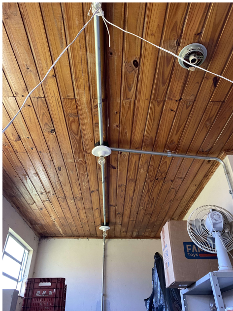
Foto 16 - Forro de madeira com manchas de umidade e pontos apodrecidos.
