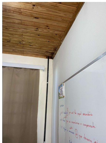
Foto 13 - Forro de madeira das salas de aula com manchas de bolor.
