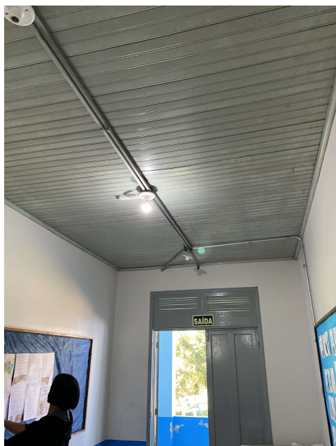
Foto 10 - Forro de madeira com manchas de bolor.
