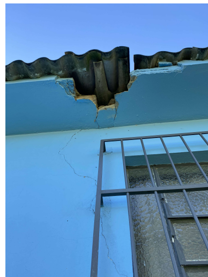
Foto 9 - Beiral da fachada lateral esquerda quebrado.
