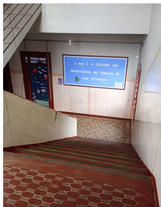
Escadaria com proteção insuficiente
