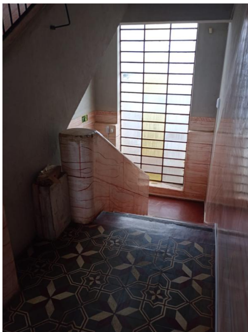
Escadaria sem corrimão lateral
