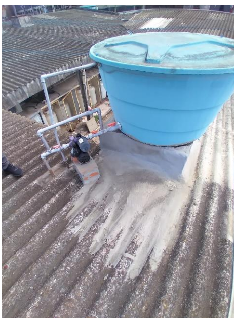
Figura 5. Reservatório de fibra com sistema de pressurização – Cobertura Bloco 8.
