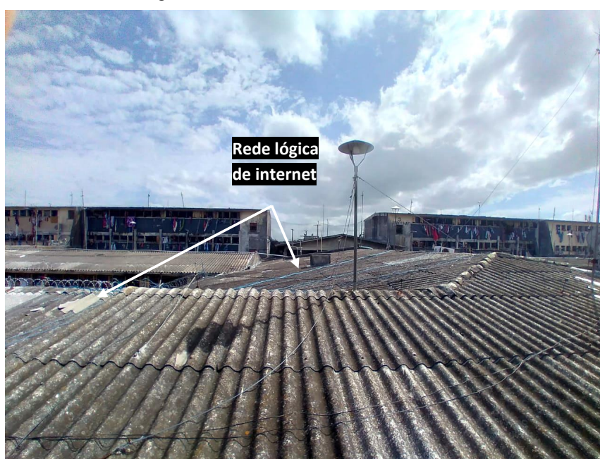
Figura 6. Rede de internet sobre a cobertura
