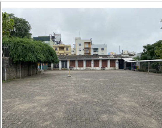
Foto 4 - Cobertura danificada - Prédio 5.
