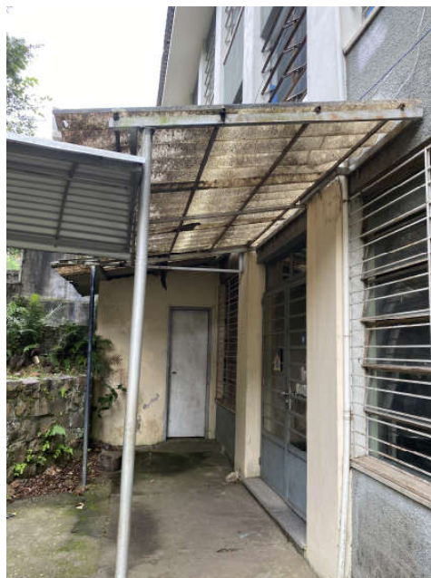
Foto 9 - Cobertura danificada - Prédio 5.
