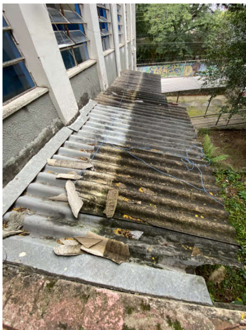
Foto 8 - Cobertura danificada - Prédio 5.
