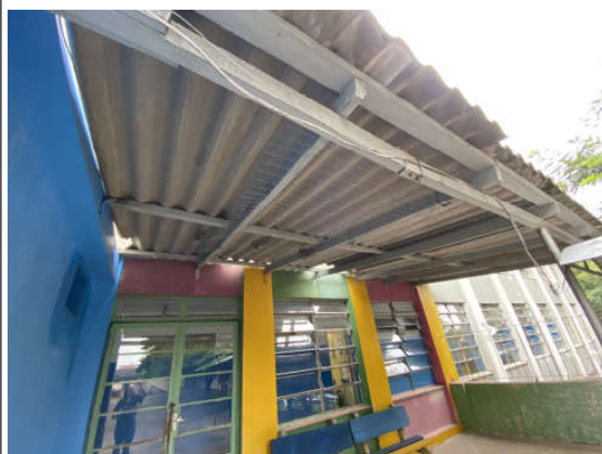
Foto 6 - Cobertura danificada - Prédio 5.
