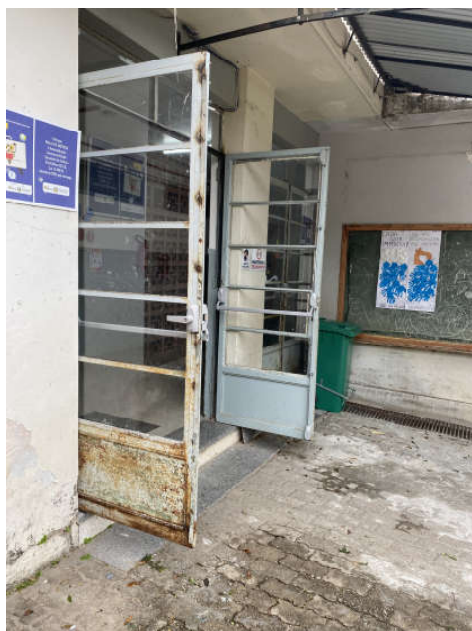
Foto 16 - Portas de acesso danificadas - Prédio 5.
