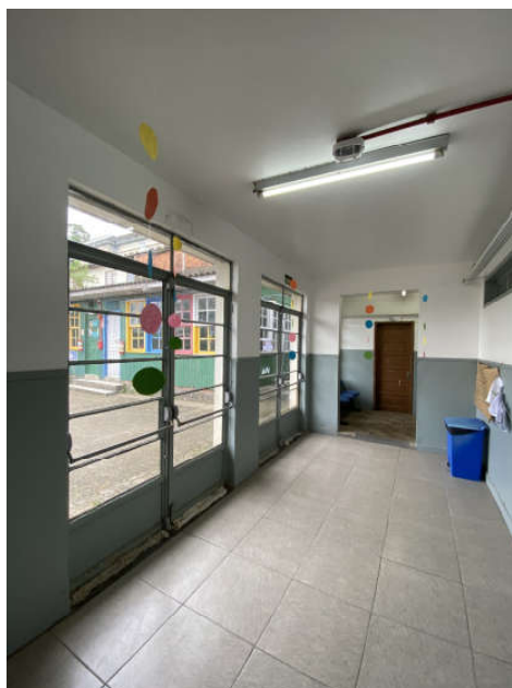
Foto 17 - Portas de acesso danificadas - Prédio 5.
