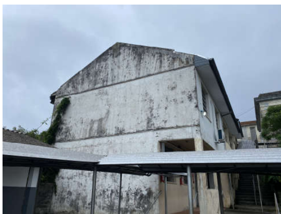
Foto 12 - Cobertura danificada - Prédio 3.
