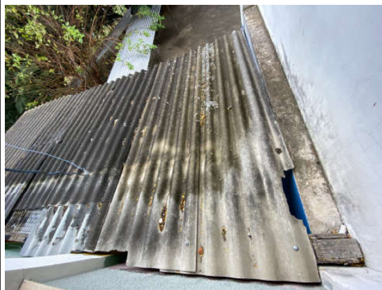
Foto 5 - Cobertura danificada - Prédio 5.
