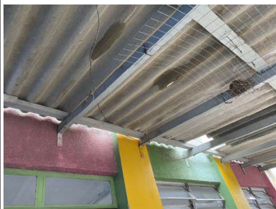
Foto 7 - Cobertura danificada - Prédio 5.
