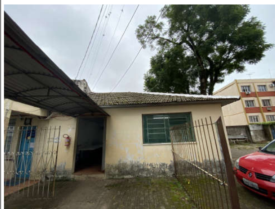
Foto 3 - Cobertura danificada - Prédio 3.
