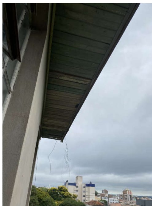
Foto 13 - Cobertura danificada - Prédio 3.
