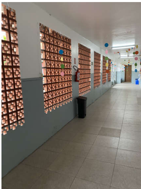
Foto 18 - Vão com peças vazadas que acumulam água no piso - Prédio 5.
