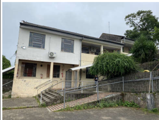
Foto 11 - Cobertura danificada - Prédio 3.
