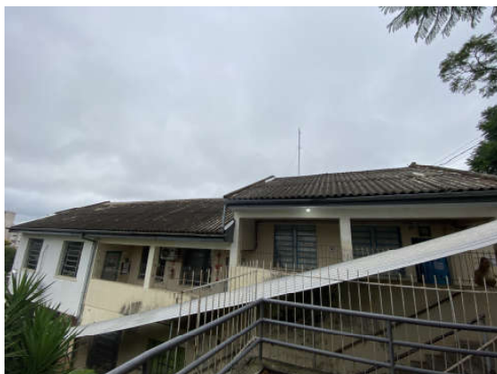
Foto 10 - Cobertura danificada - Prédio 3.
