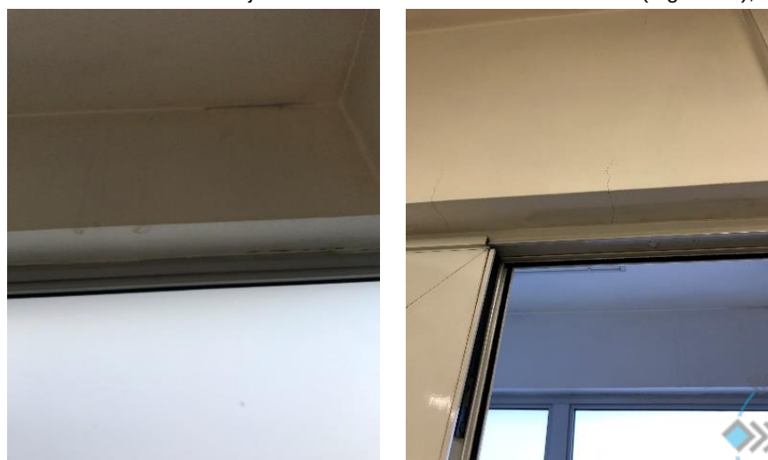
Figura 31 - Rachaduras e sujeira no forro;
