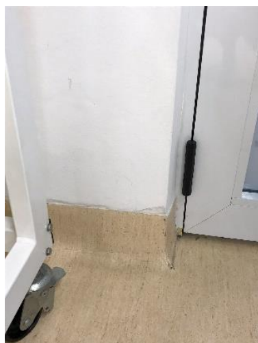
Figura 36 - Rachadura no encontro entre o rodapé e a parede;
