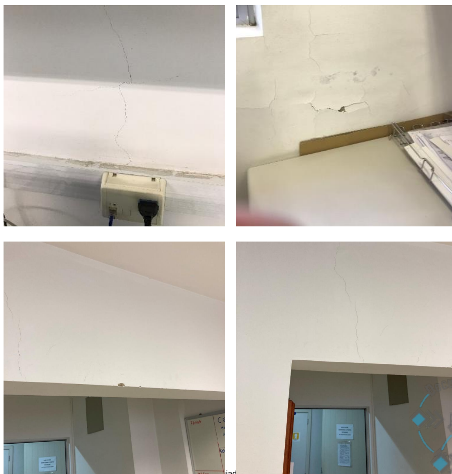
Figura 45 - Paredes com bolhas, rachaduras e danificadas;
