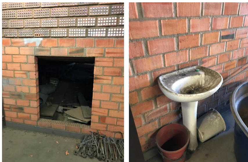
Figura 13 - Depósito de entulhos e pia desativada;
