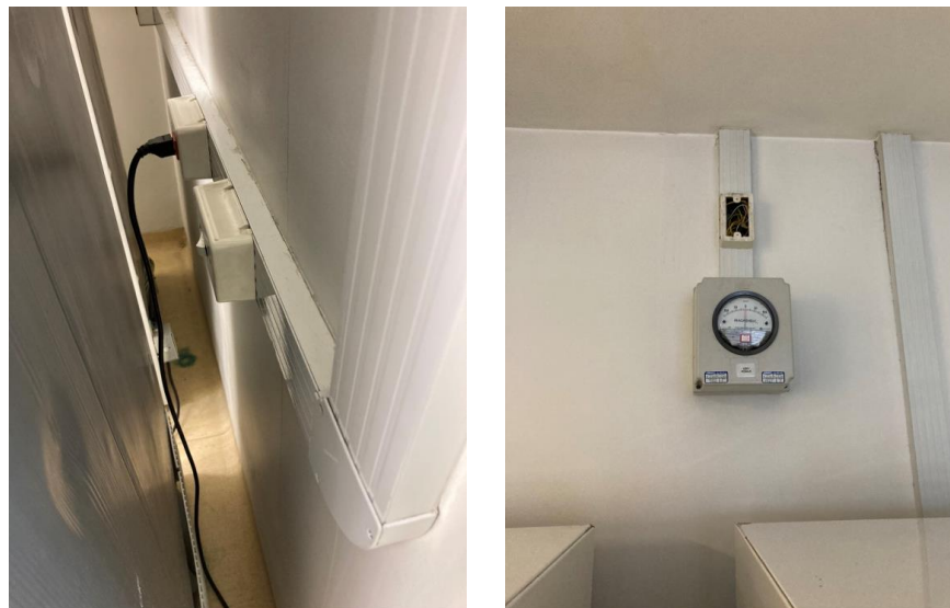
Figura 30 - Posição do interruptor e acabamento de tomada faltando;
