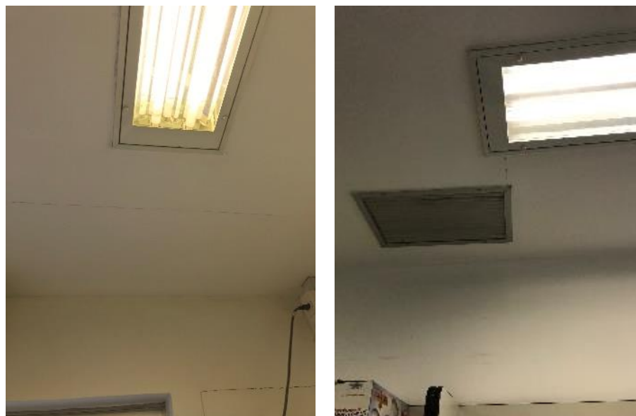
Figura 46 - Forro apresenta manchas e rachaduras e luminárias faltando;
