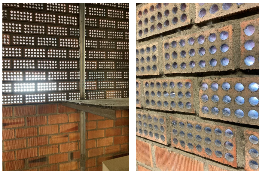
Figura 9 - Blocos vazados para ventilação com muita fuligem;
