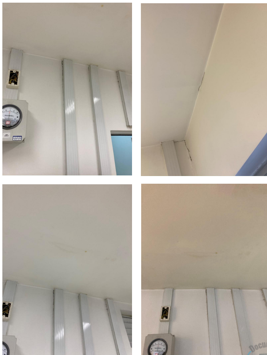
Figura 29 - Forro com manchas de umidade e algumas rachadura no encontro com a parede;
