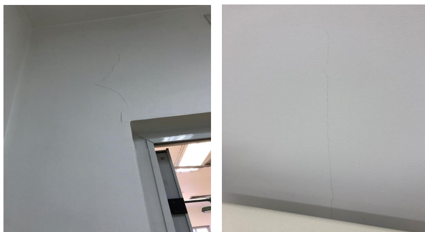
Figura 20 - Rachaduras nas paredes;
