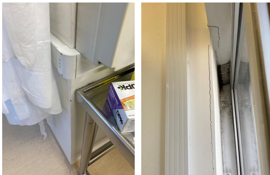
Figura 24 - Rachadura no encontro de diferentes materiais e quina sem reboco;
