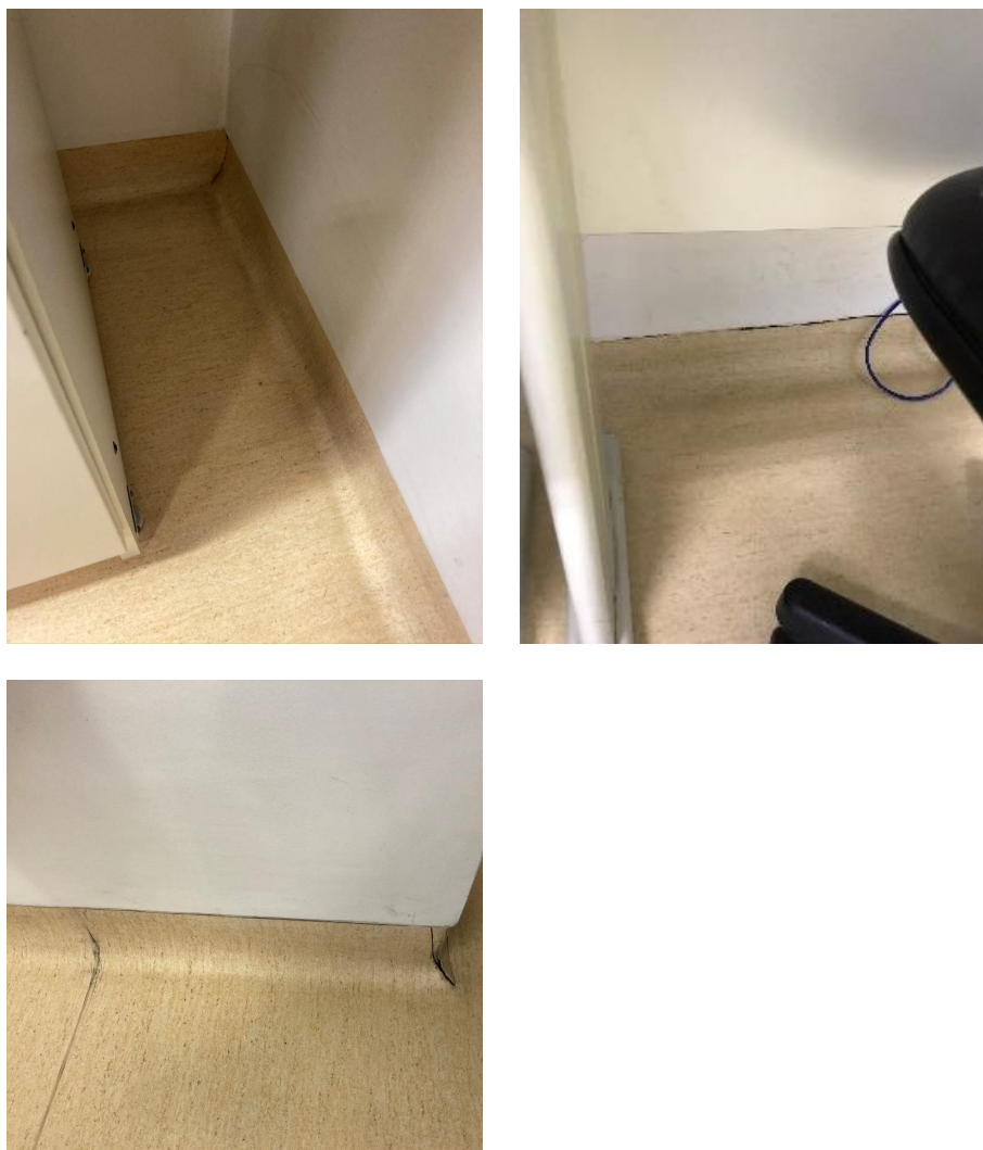
Figura 48 - Rodapés com rachaduras e danificados;
