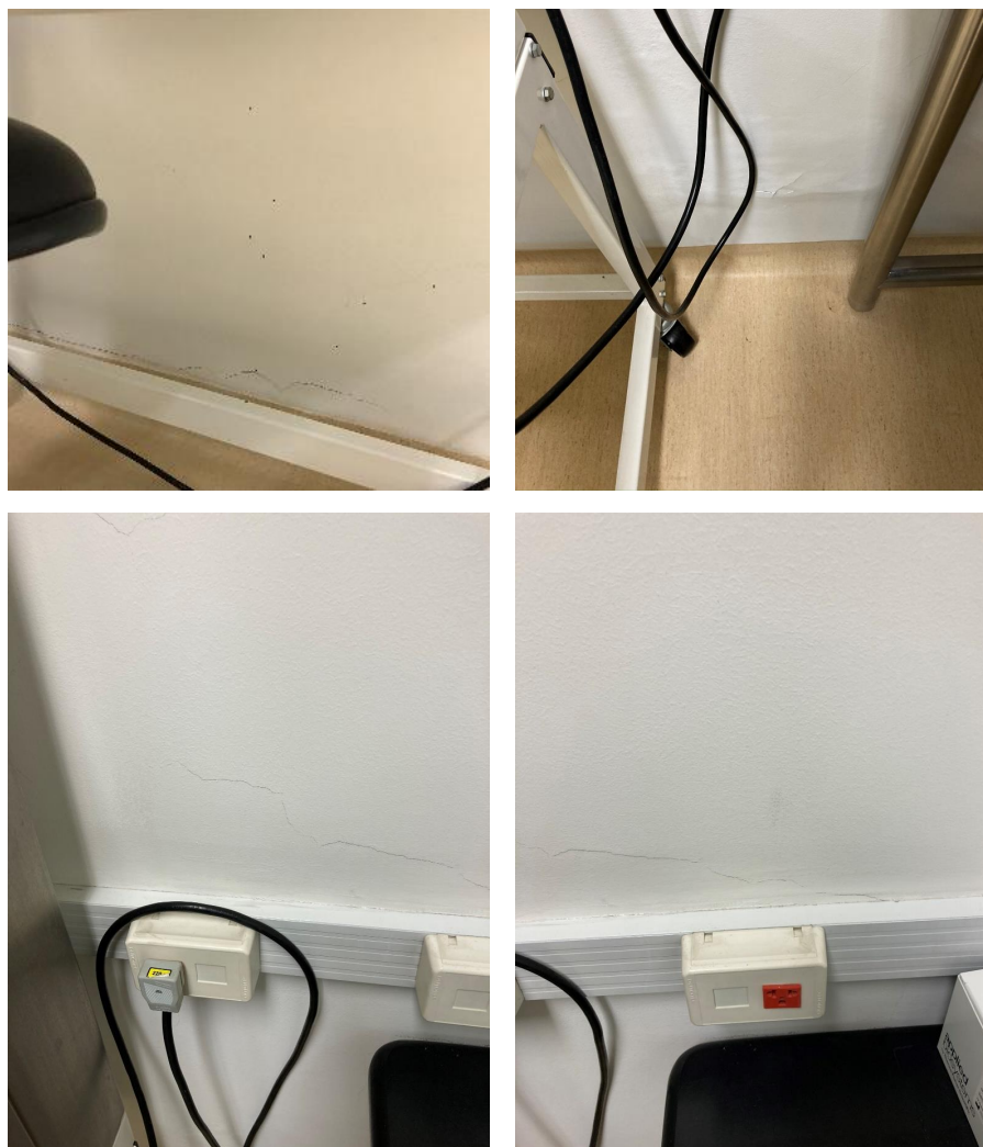
Figura 35 - Rachaduras e bolhas nas paredes;
