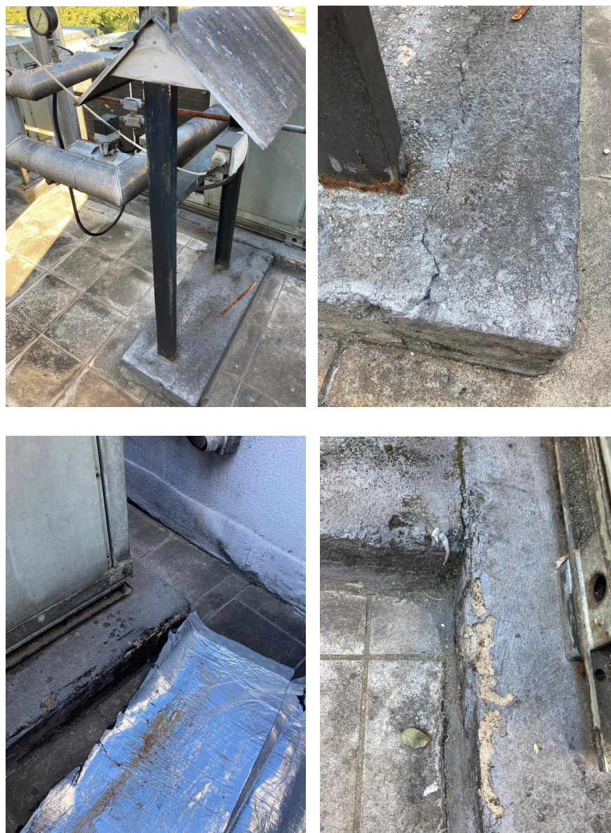
Figura 5 - Rachaduras e desgastes nas estruturas de suporte aos equipamentos;
