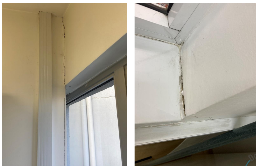
Figura 23 - Rachaduras no encontro entre diferentes materias;
