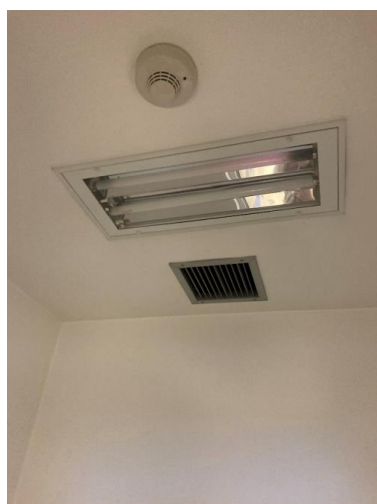
Figura 37 - Rachaduras no forro e luminária com lâmpadas queimadas;
