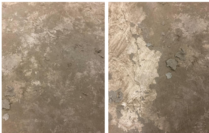
Figura 11 - Piso apresentando desgaste e soltando pedaços;
