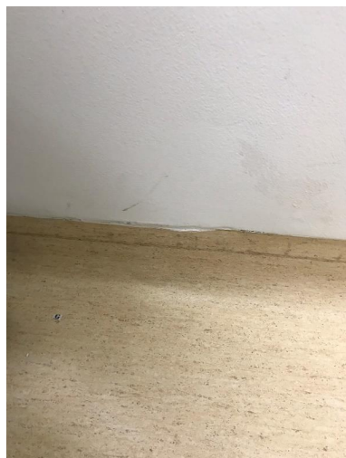
Figura 19 - Rodapé descolando da parede;
