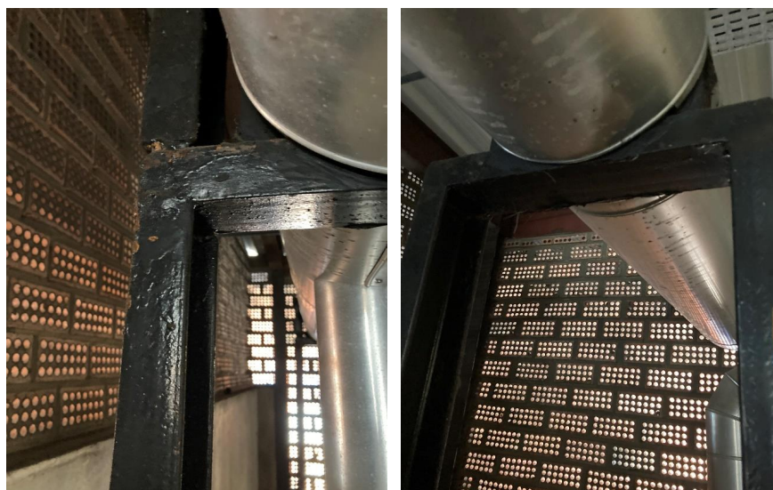
Figura 10 - Estruturas de suporte com oxidações;
