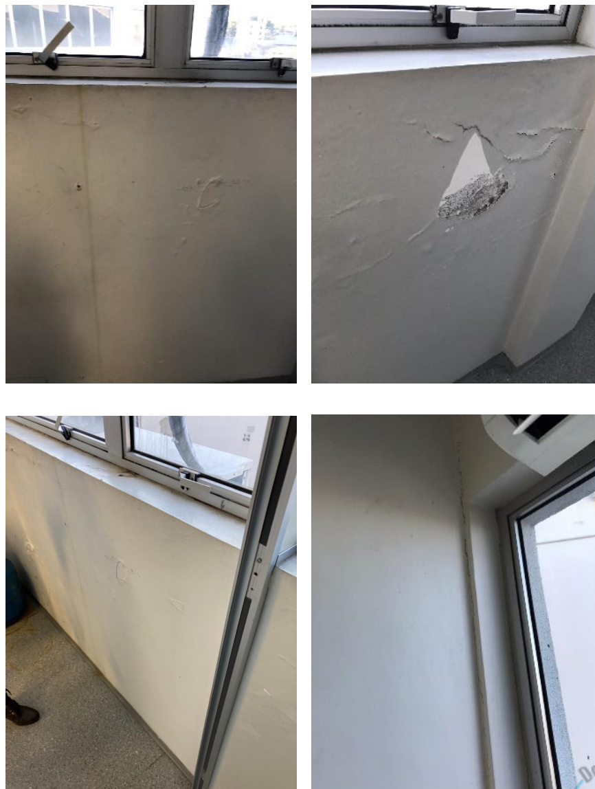
Figura 42 - Paredes com rachaduras, bolhas e sem reboco;
