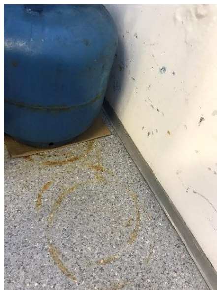
Figura 43 - Piso com rachaduras, marcas de ferrugem e rodapé descolando;
