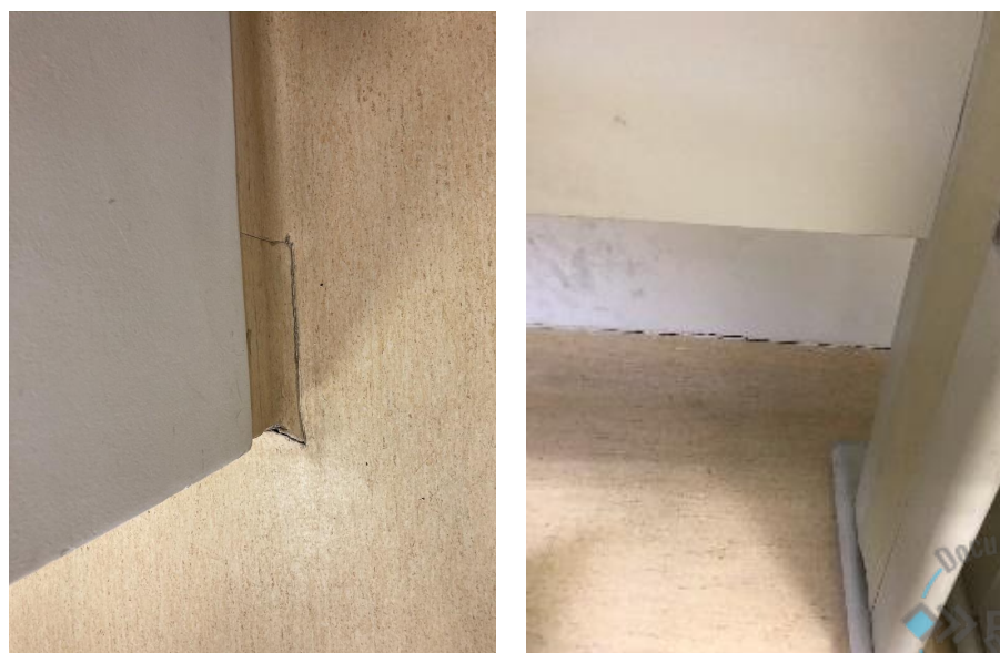
Figura 47 - Rodapés danificados e com rachaduras;
