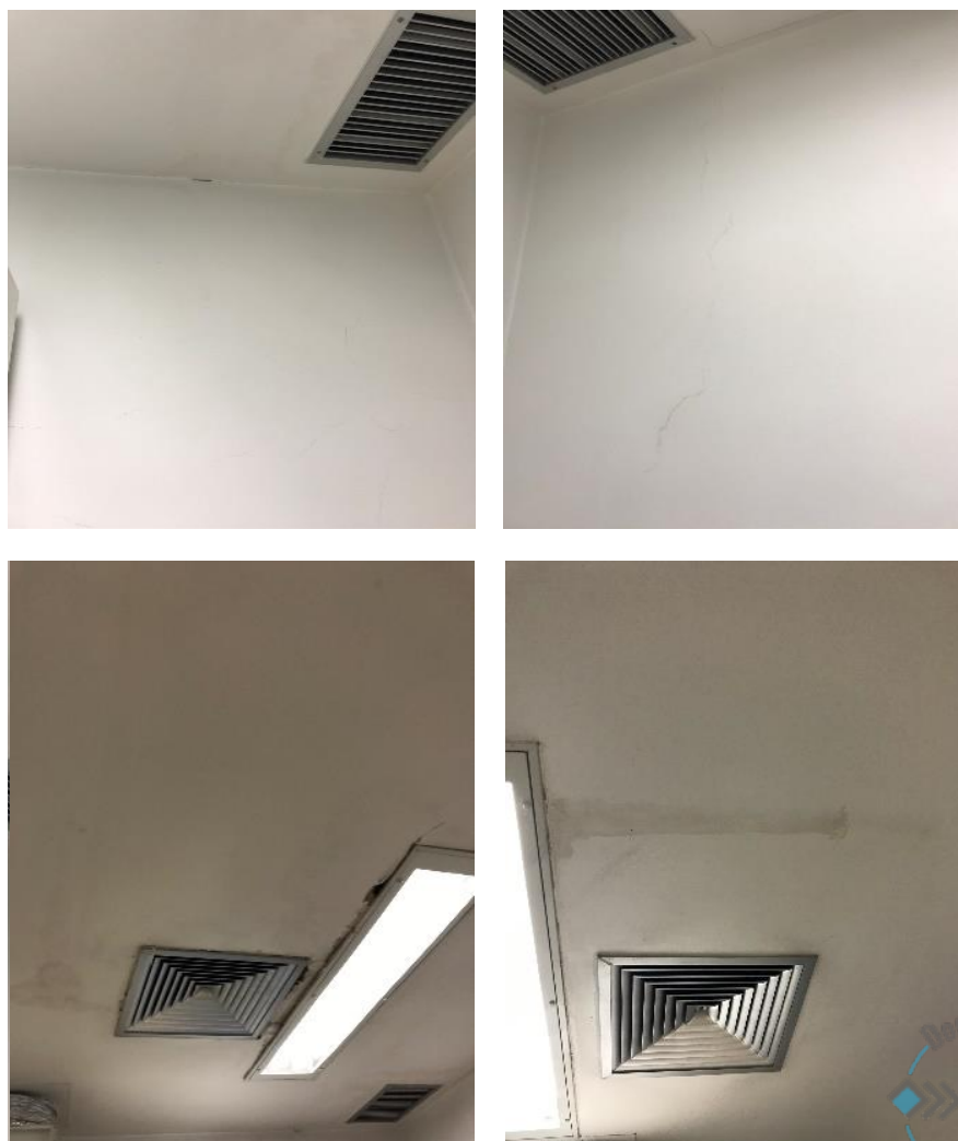
Figura 34 - Forro com manchas, bolhas e sujeira. Marcas de ferrugem próxima a luminária;
