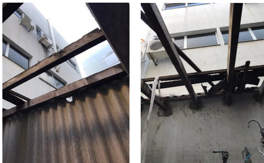
Figura 50 - Falta de telhado e estrutura danificada;
