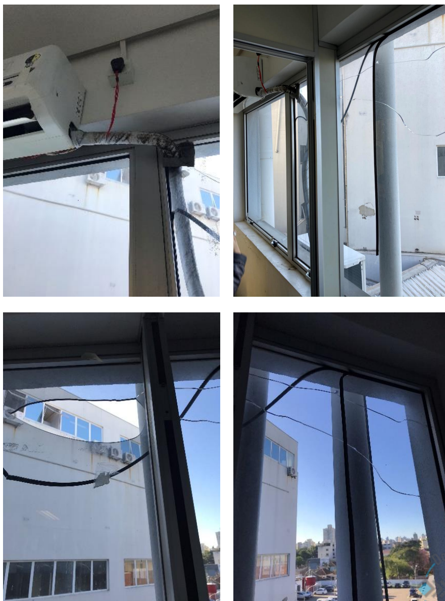
Figura 44 - Vidros recortados para passagem de tubulação de Ar-Condicionado, vidro quebrado e borracha de fixação solta;
