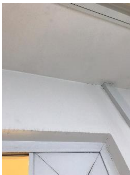
Figura 33 - Luminária com ferrugem e parede com manchas de sujeira;
