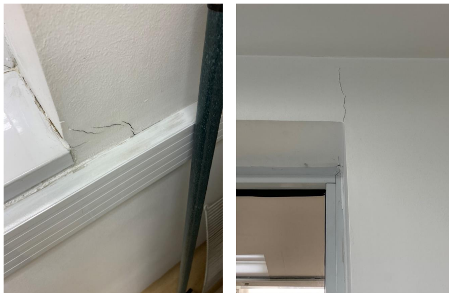
Figura 22 - Rachaduras no encontro de diferentes materias;
