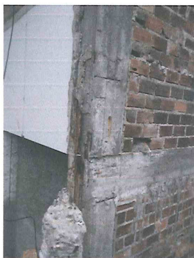
Danos e restos de edificações demolidas
