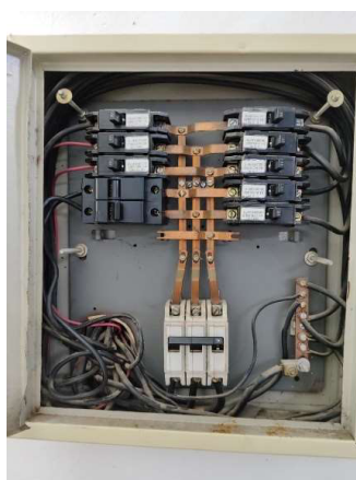
CD Geral Gerador
