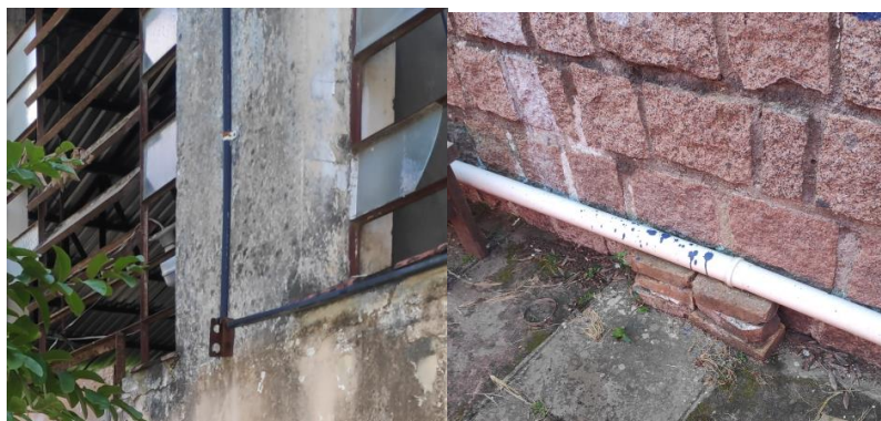
Imagem 01 e 02: Eletroduto de PVC e Duto a remover da fachada
