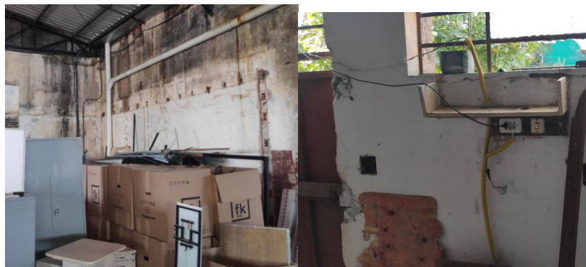
Imagem 03 e 04 : Eletrodutos de PVC a remover do bloco 02
