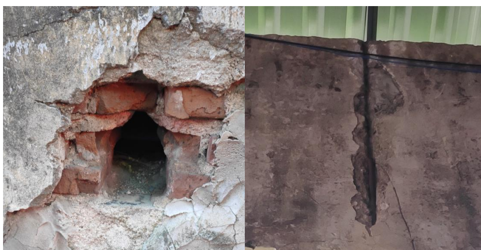
Imagem 08 e 09 : pontos críticos a restaurar
