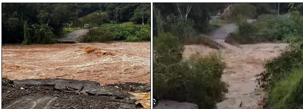
Fig. 4: Imagens da ponte sobre o arroio Não Sabia sendo levada pela força da água, em 01/05/2024.
