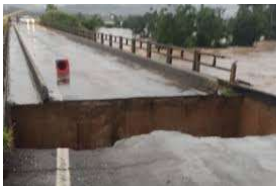
Fig. 4: Imagens da cabeceira da ponte após o sinistro, em 30/04/2024.
