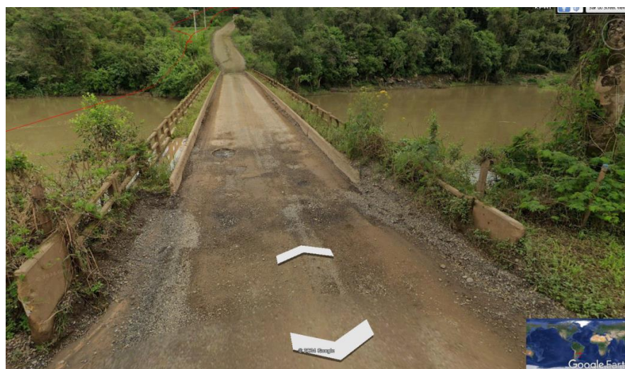
Fig. 2: Imagem de satélite do Google Earth da ponte sobre o arroio Não Sabia, com extensão original de 70m antes do sinistro (imagem de junho/2023)
