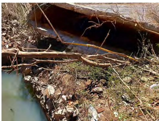
Figura 21 - Entulho da ponte
