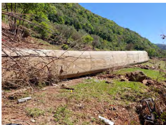
Figura 17 - Entulho da ponte
