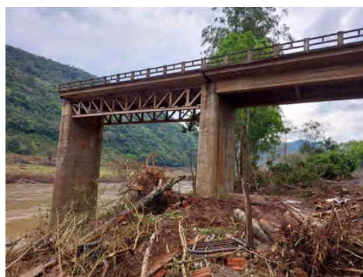
Figura 14 - Entulho da ponte
