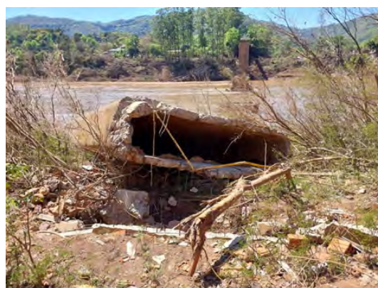
Figura 16 - Entulho da ponte
