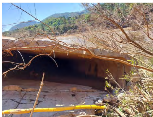
Figura 22 - Entulho da ponte
