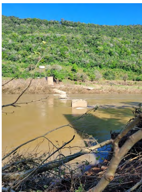
Figura 1 – Elementos remanescentes da ponte.
