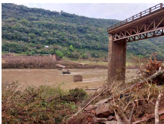
Figura 13 - Entulho da ponte
