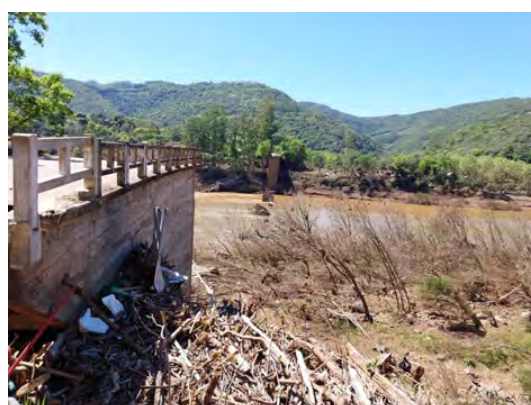
Figura 28 - Entulho da ponte
