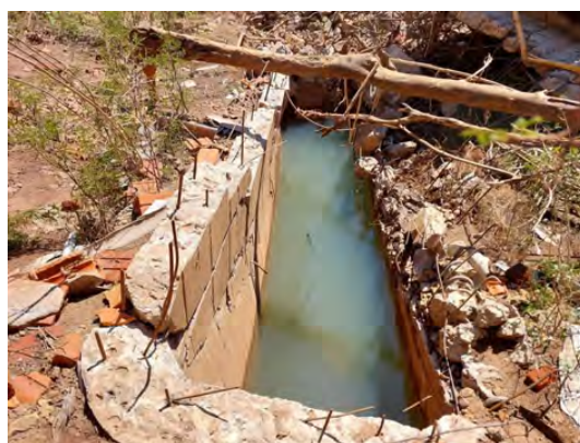
Figura 20 - Entulho da ponte
