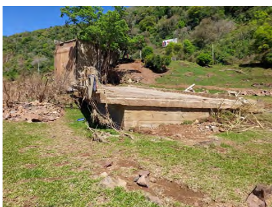
Figura 27 - Entulho da ponte
