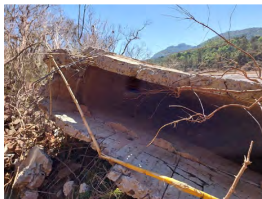
Figura 24 - Entulho da ponte
