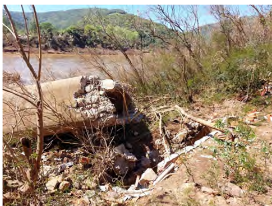
Figura 23 - Entulho da ponte
