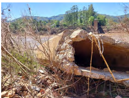
Figura 19 - Entulho da ponte
