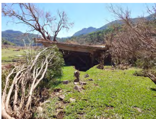
Figura 15 - Entulho da ponte
