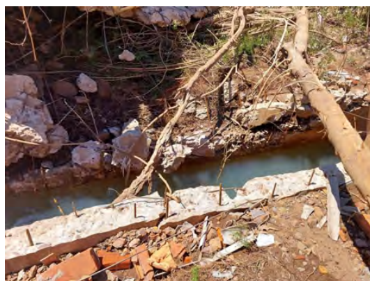
Figura 18 - Entulho da ponte
