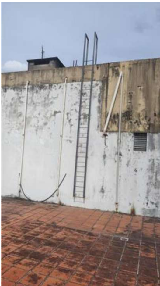
Escada marinheiro: proteção de 4,60 m.
