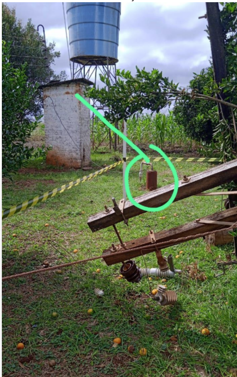
Foto 2: Bomba do poço artesiano sem alimentação elétrica
