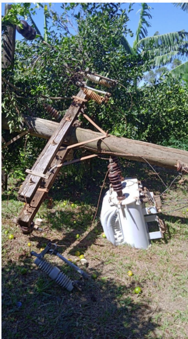
Foto 1: Poste e transformador tombados
