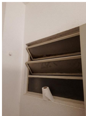
Figura 8 Janelas basculantes voltadas para o poço de ventilação sem iluminação natural. Algo sem solução.
