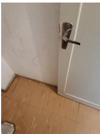
Figura 19 Péssimo estado de conservação do piso e rodapés. As esquadrias, ferragens e demais elementos também devem ser substituídos.
