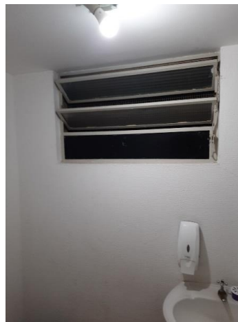
Figura 22 Iluminação somente artificial. Deve ser substituída por plafons LED.
