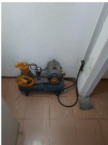
Figura 15 Compressor de ar a ser removido.
