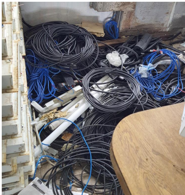
Foto 9 – Lâmpadas em meio a fios e cabos no piso
