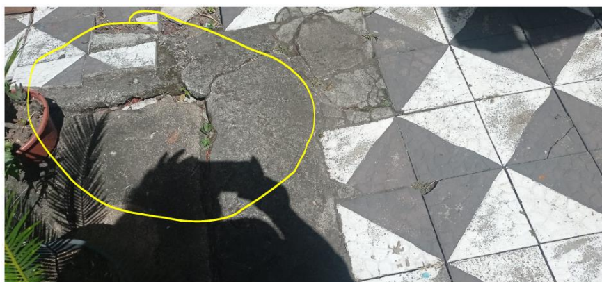
Infiltração sob o piso do patio junto a caixas e fossa
