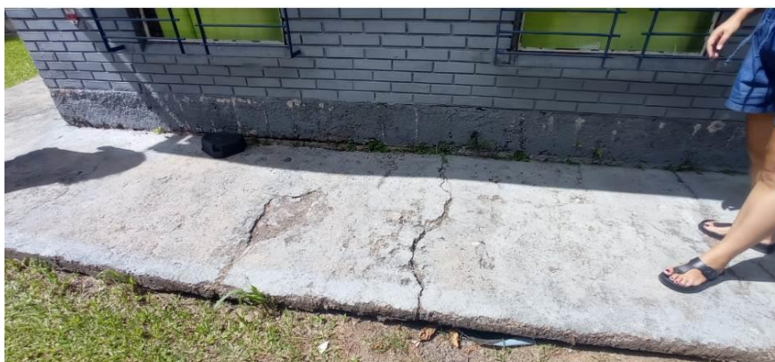
O piso de concreto esta sem base firme, com espaço e com rachaduras
