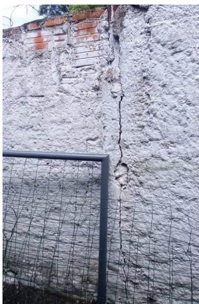
Muro com rachadura
