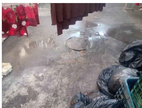
Foto 06 – Provável Filtro Anaeróbio - Pátio
