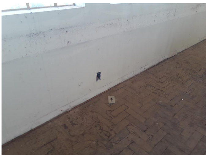
Tomadas, fios, rodapés e barras de proteção de paredes furtados.
