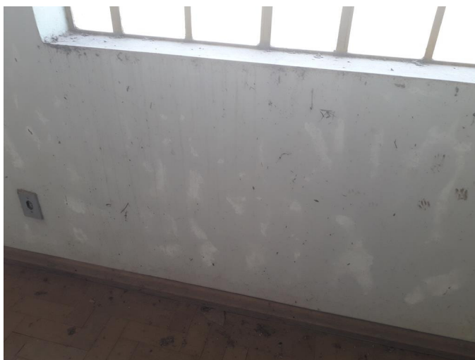
Infiltrações e pintura danificada.
