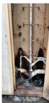
Foto 01 – Detalhe Shafts – Módulo IV
