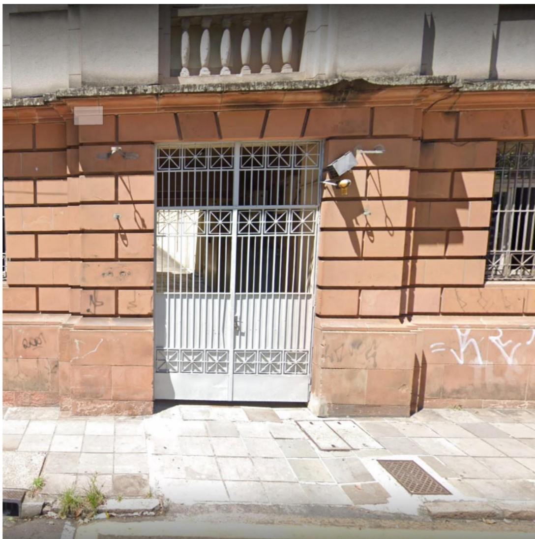
Entrada 02 da Rua Riachuelo. Observa-se a ausência de barreiras para entrada de P.C.R.
