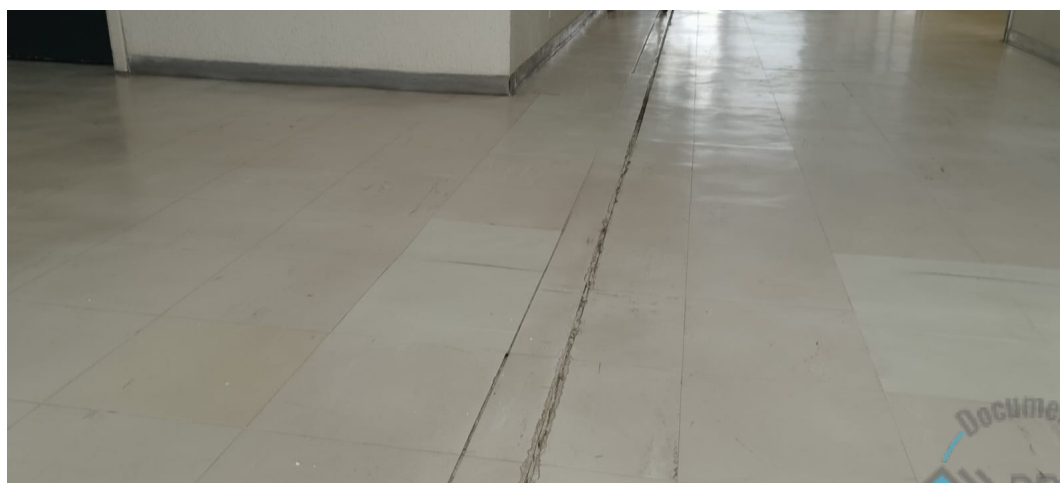
Imagem 01: Na figura, podemos ver o aspecto da junta de dilatação com ausência de arremates, podendo vir, até mesmo, a causar acidentes envolvendo os usuários de algumas alas do Edifício-Sede.
