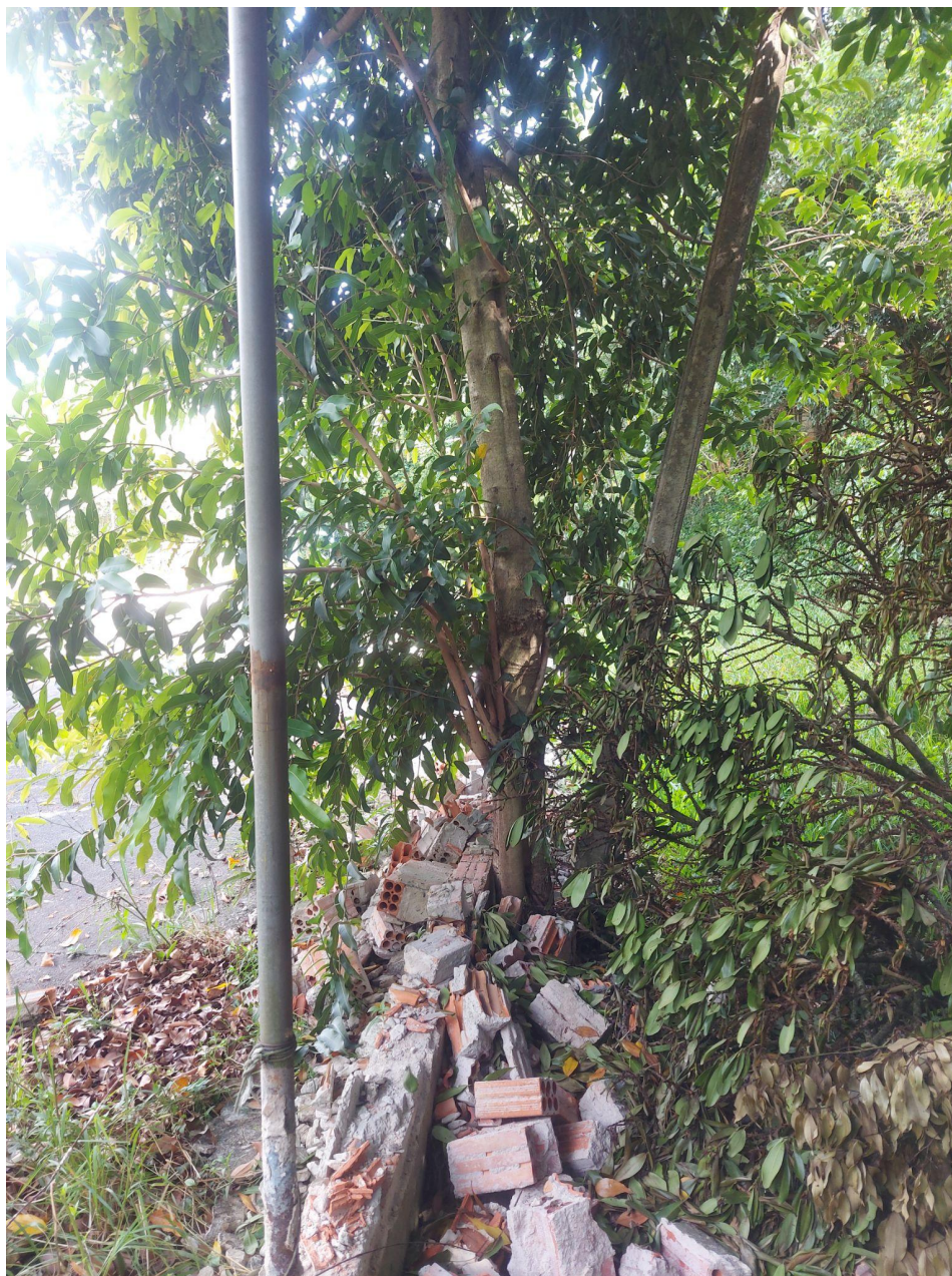
Figura 4. Detalhe mostrando conflito da árvore nº 1 com a mureta e o alambrado da quadra de esportes.
