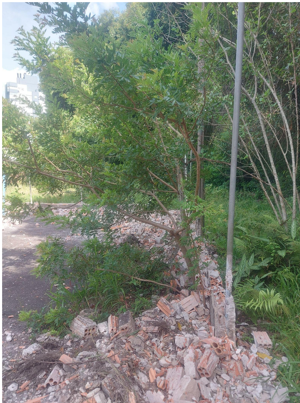
Figura 10. Detalhe mostrando conflito da árvore nº 4 com a mureta e o alambrado da quadra de esportes.
