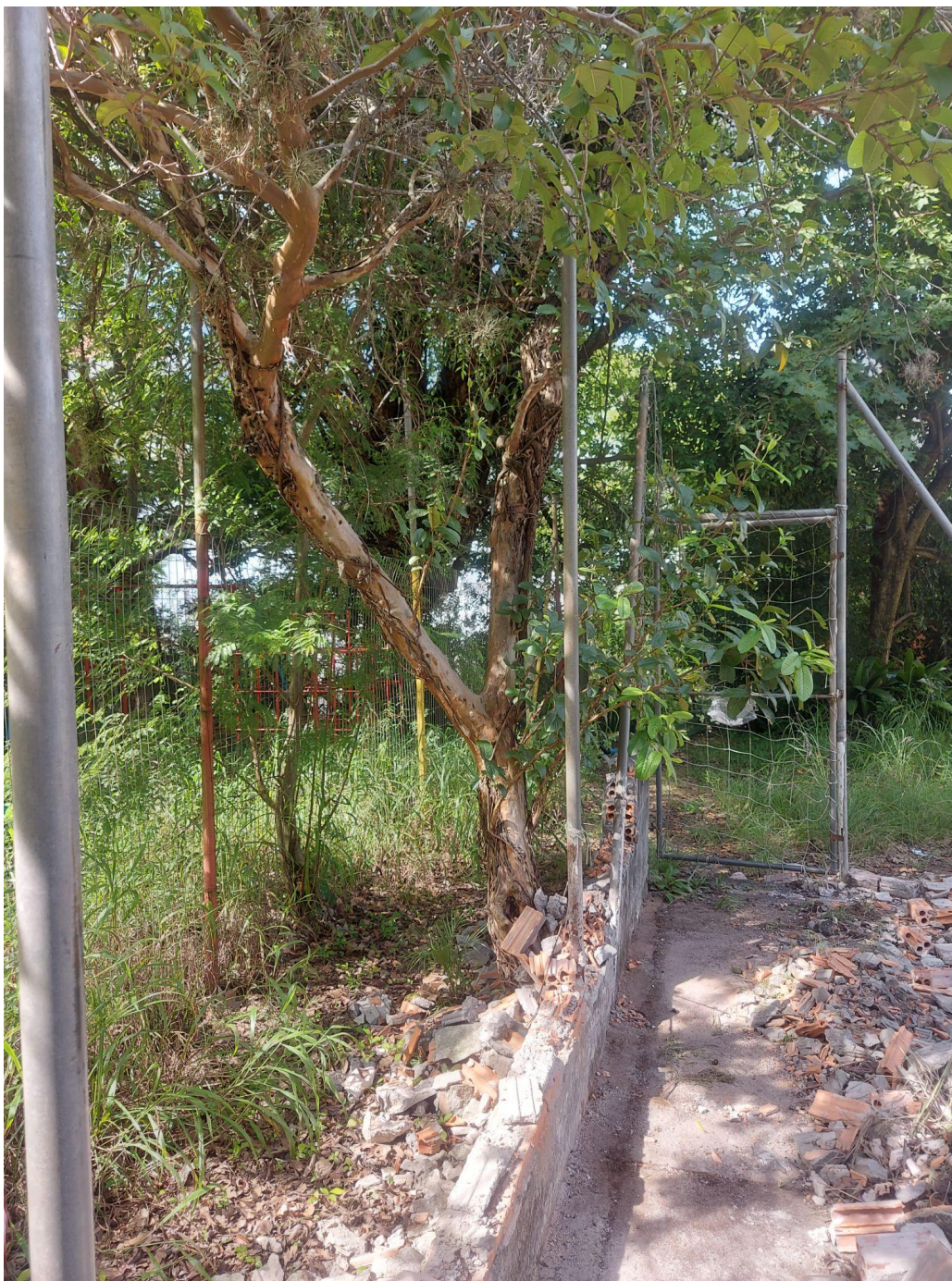
Figura 8. Detalhe mostrando conflito da árvore nº 3 com a mureta e o alambrado da quadra de esportes.
