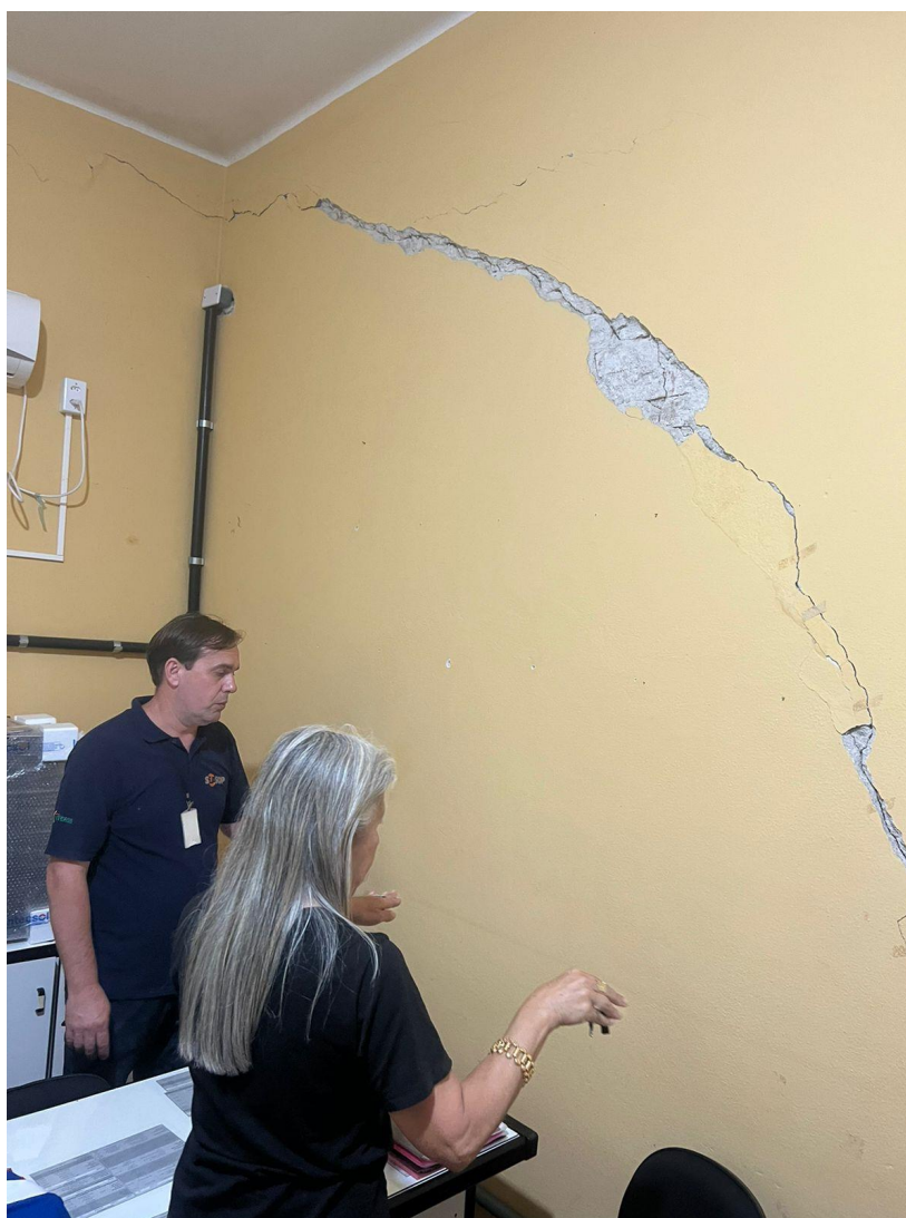
Figura 2: Parede com recalque diferencial
