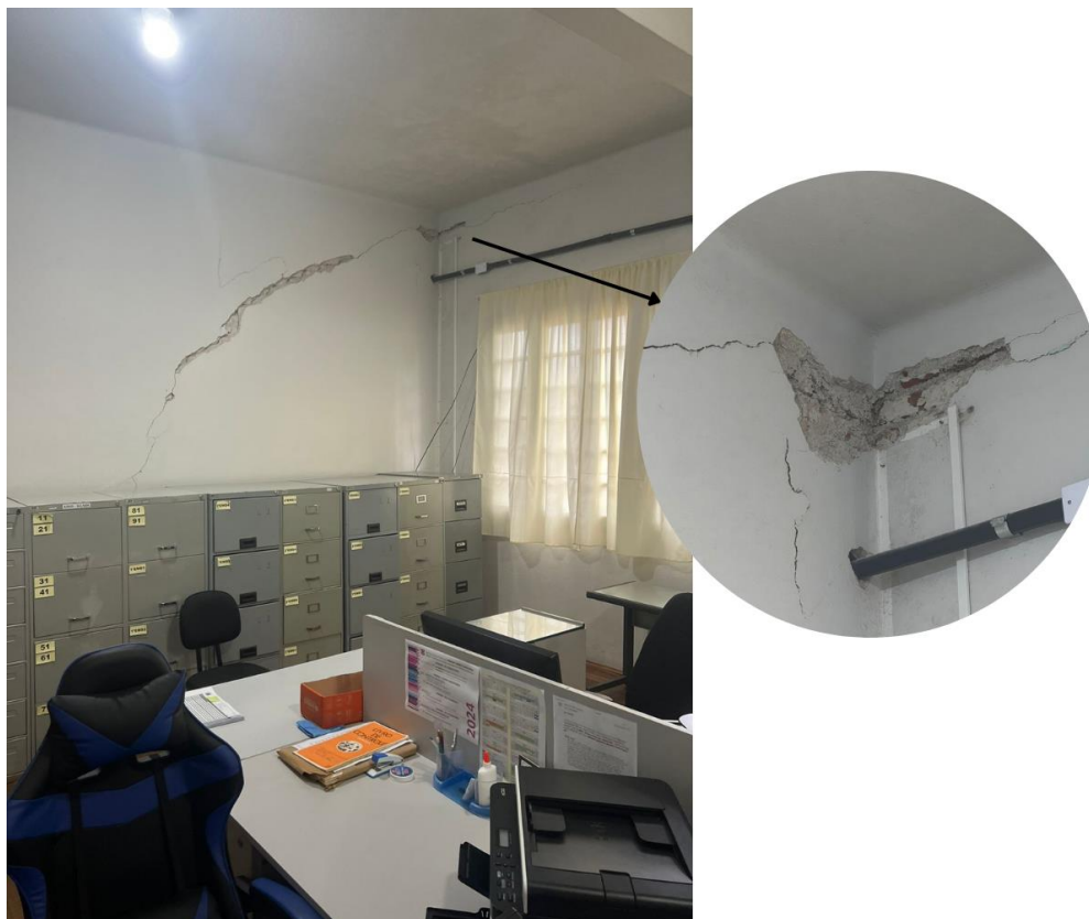
Figura 3: Lado oposto da parede com patologia
