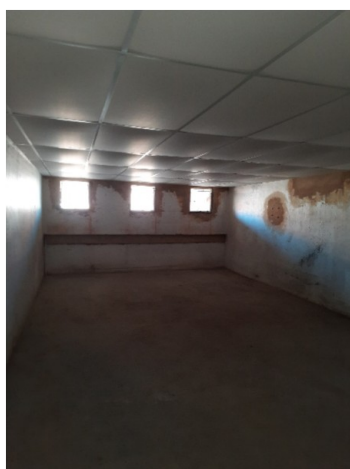
Figura 10 Sala 02: Pé direito baixo com forro mineral. Paredes em péssimo estado.
