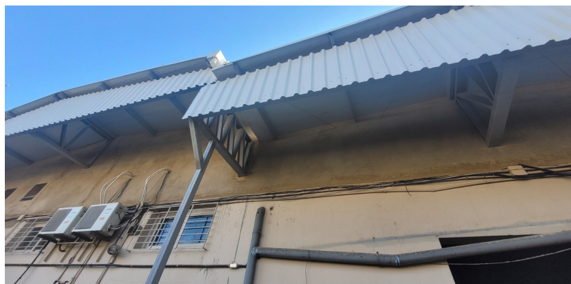
Figura 23 Tubulação e fiação ociosa a ser retirada.
