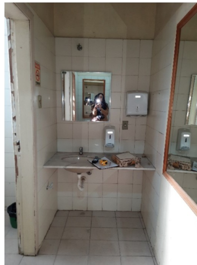
Figura 5 Equipamentos em estado regular a ruim. Cabines em alvenaria.
