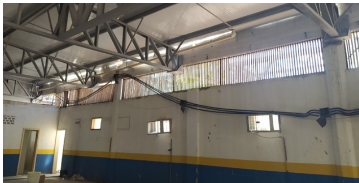
Figura 21 Tubulação e fiação ociosa a ser retirada.
