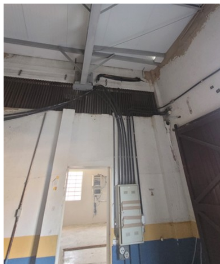
Figura 22 Tubulação e fiação ociosa a ser retirada.
