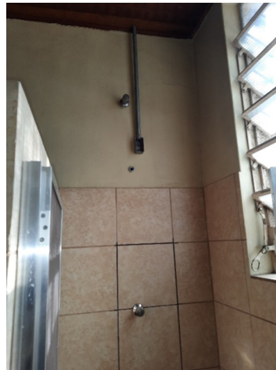
Figura 7 Cabine de banho sem chuveiro e porta em alumínio e acrílico.
