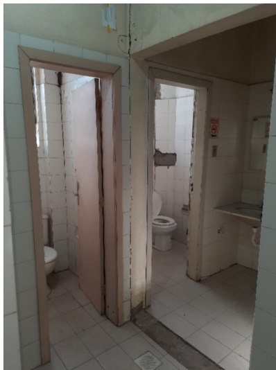
Figura 4 Sanitário Feminino: Desnível acentuado no piso. Fissura nas emendas de parede.
