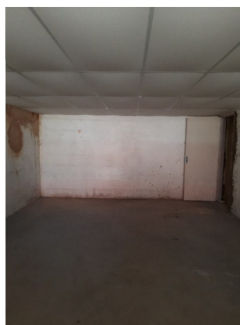
Figura 11 Piso em desnível e porta em mau estado.
