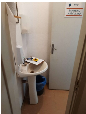
Figura 11 Sanitário Masculino com área de lavatório pequena.
