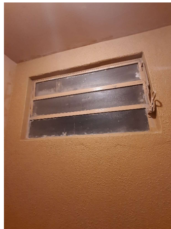
Figura 18 Tinta escura e nenhuma iluminação natural. Janela voltada para o poço de ventilação.
