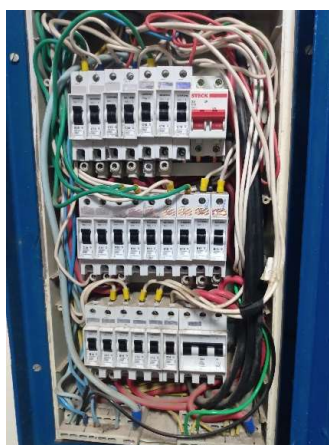
Foto 3: quadro número 3, quadro corredor circulação
