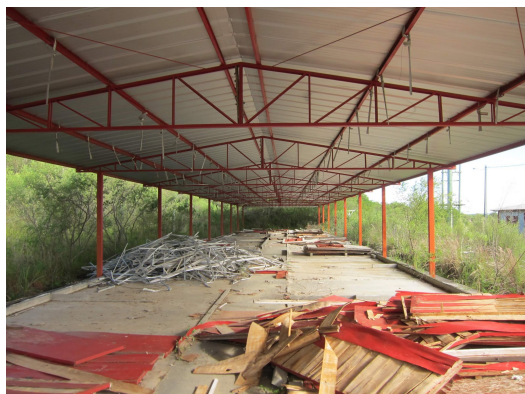
Foto 03: Resíduos de galpões danificados.
