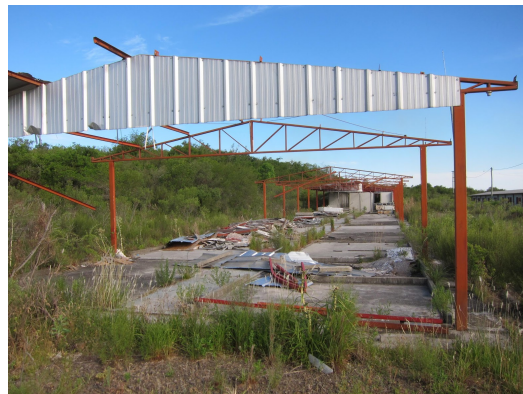
Foto 04: Resíduos de galpões danificados.
