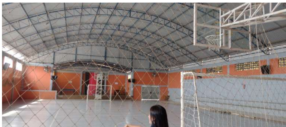
Foto 26: Ginásio de Esportes sem ventilação adequada e sem acessibilidade aos sanitários que ficam localizados na parte de baixo.
