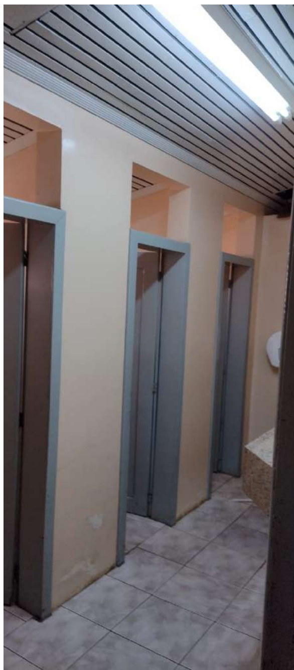
Foto 17: Acesso interno dos banheiros com portas de 60cm, pé direito baixo e sem acessibilidade.
