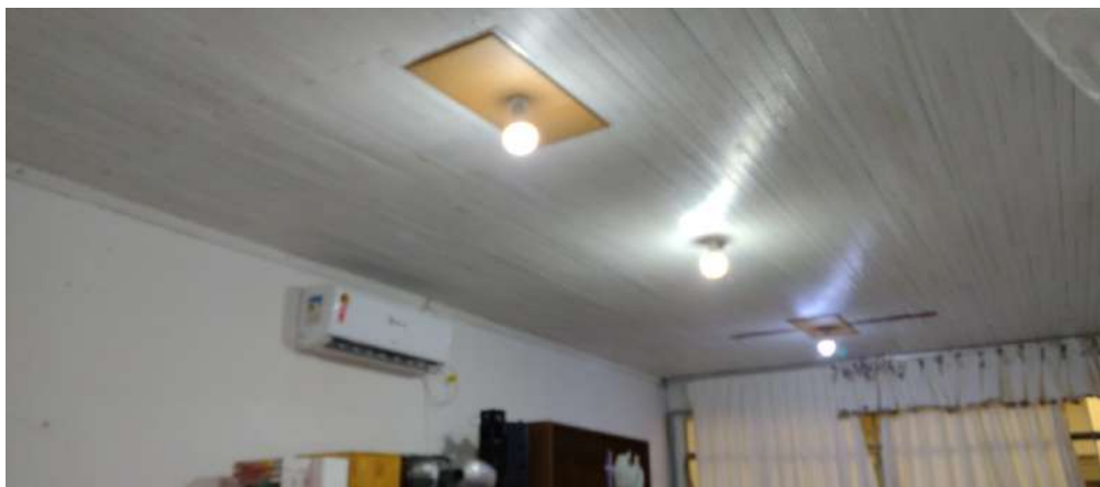
Foto 03: Forro da Sala dos Professores em situação precária e com iluminação insuficiente.
