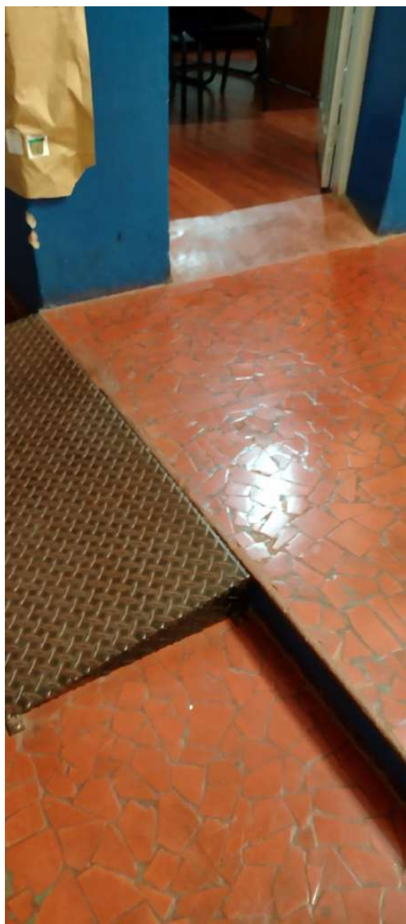
Foto 20: Desníveis internos com rampas provisórias fora dos padrões das normas técnicas não atendendo assim os critérios de acessibilidade
