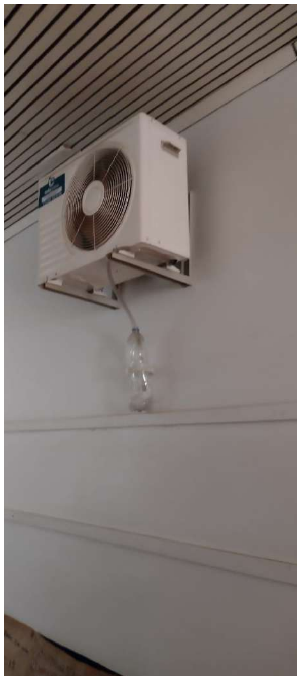
Foto 21: Instalações incompatíveis com as normas técnicas.
