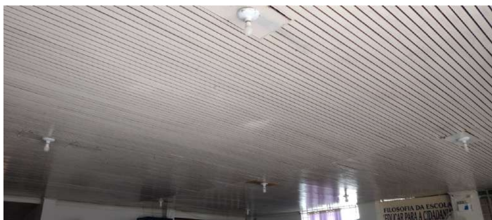
Foto 13: Forro de madeira frizada do refeitório / pátio interno onde vemos a iluminação artificial precária.
