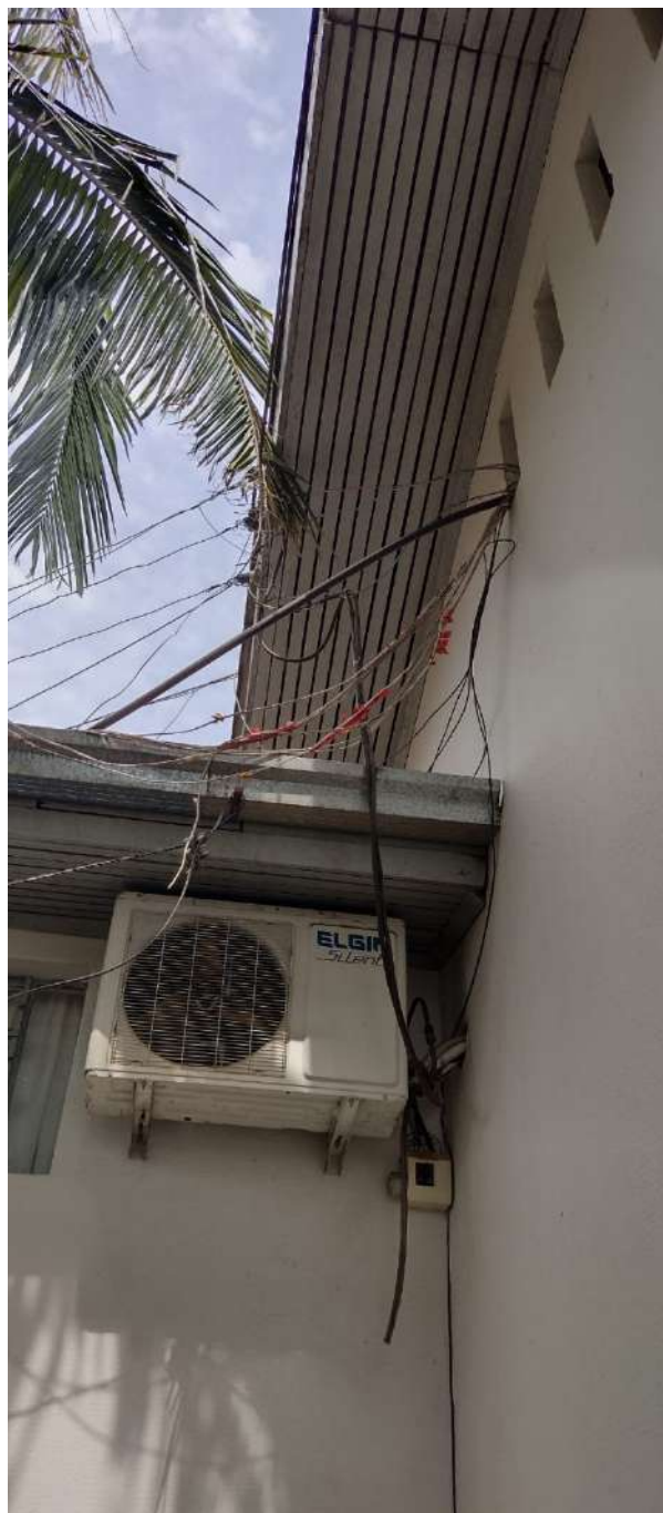
Foto 24: Instalações elétricas precárias.
