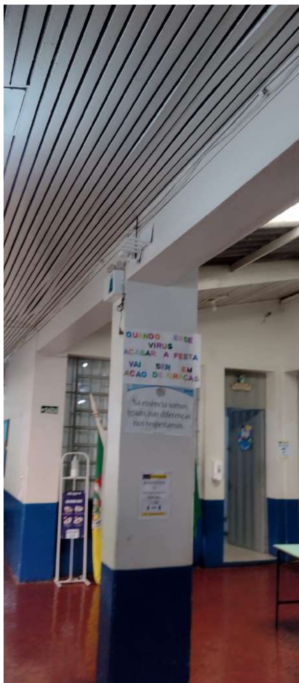
Foto 25: Instalação de Internet que não atendem a demanda da escola.
