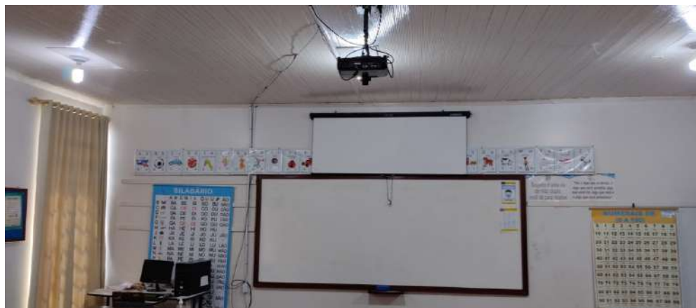
Foto 10: Sala de aula com equipamentos de mídia digital e data show, porém com instalações fora das Normas técnicas recomendadas.
