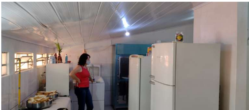
Foto 14: Cozinha com pé direito baixo, em torno de 2,00m, local com ventilação e iluminação natural precária.
