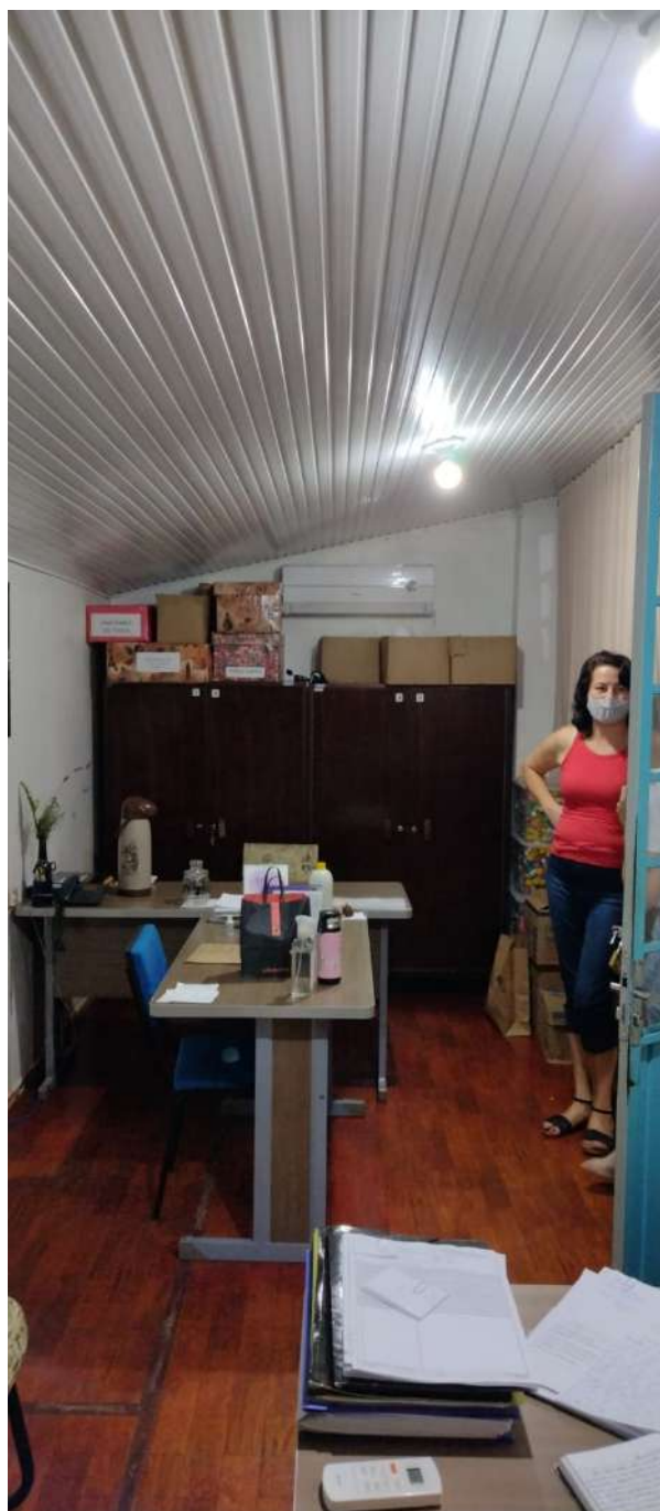
Foto 08: Sala administrativa com pé direito abaixo de 2,30m, sem ventilação e iluminação natural.
