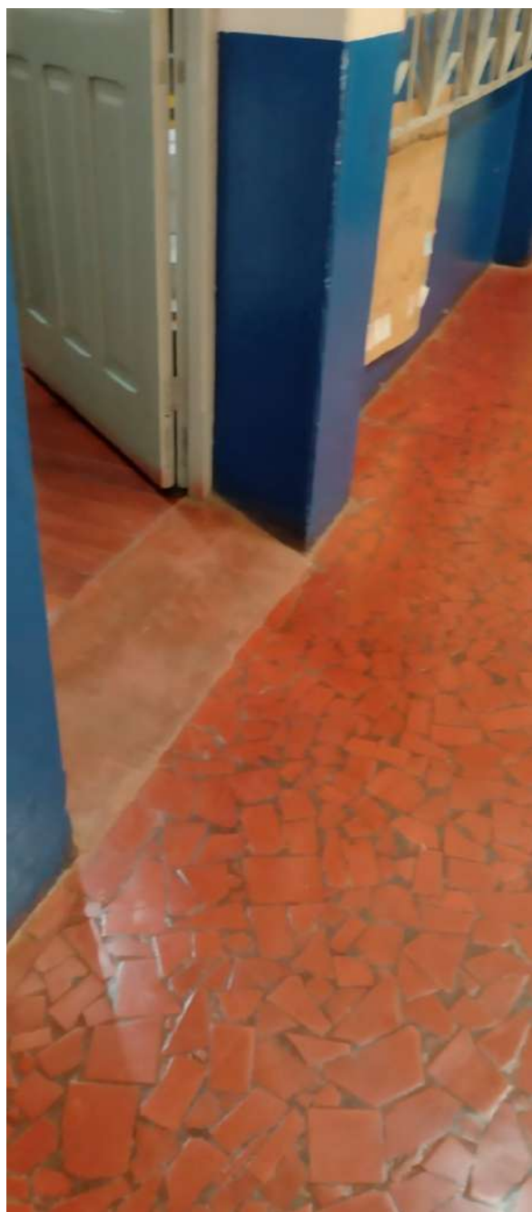
Foto 19: Desníveis internos com rampas provisórias fora dos padrões das normas técnicas não atendendo assim os critérios de acessibilidade.
