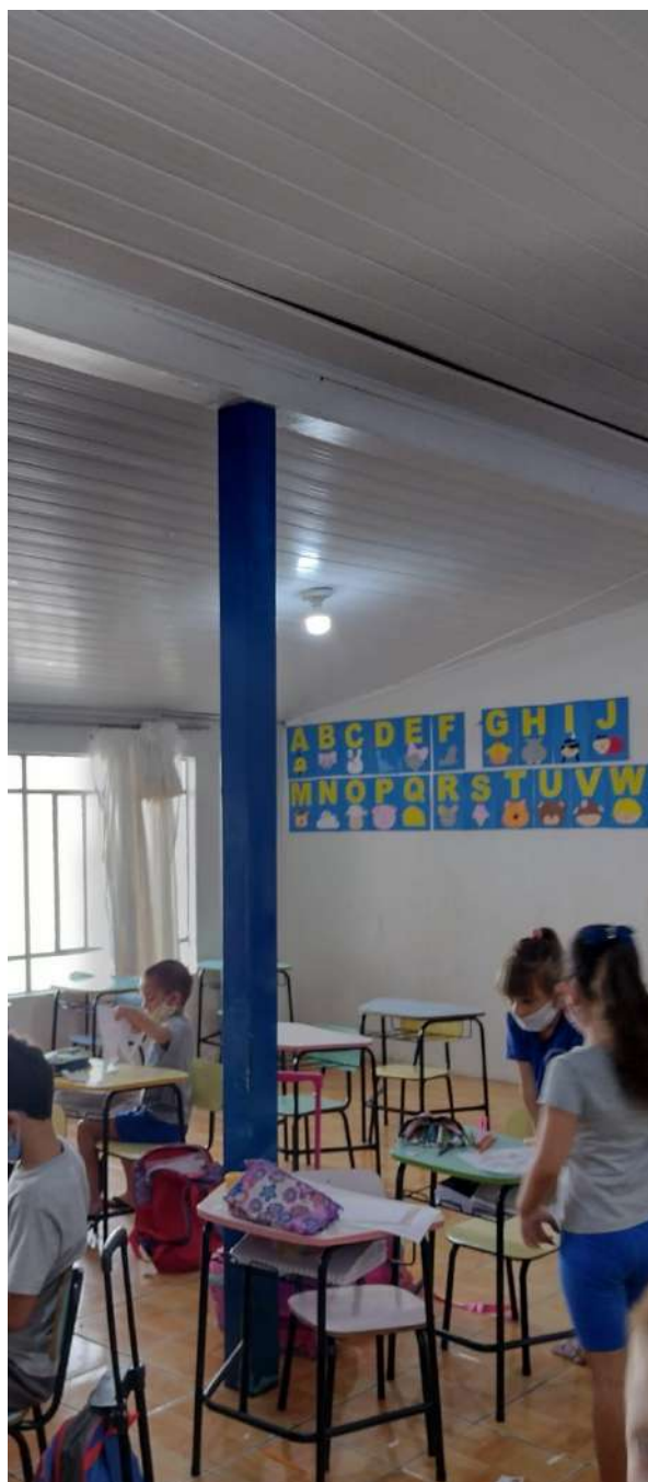
Foto 07: Sala de Pré escola com pé direito menor que 2,30m e pilar no meio da sala, atrapalhando a visibilidade ate o quadro escolar.
